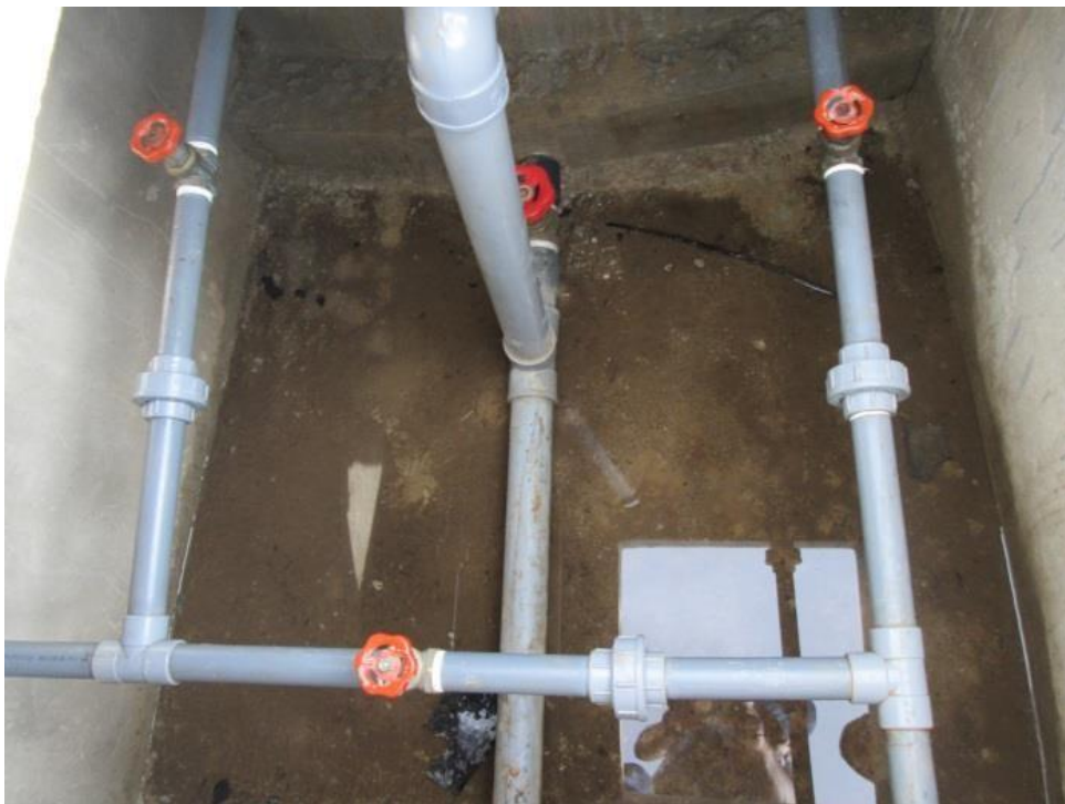
FUENTE: Elaboración propia. Caseta de válvula con accesorios de PVC en buen estado de conservación con tuberías de ingreso y salida de Ø1", y con tubería de rebose y limpia de Ø2".
