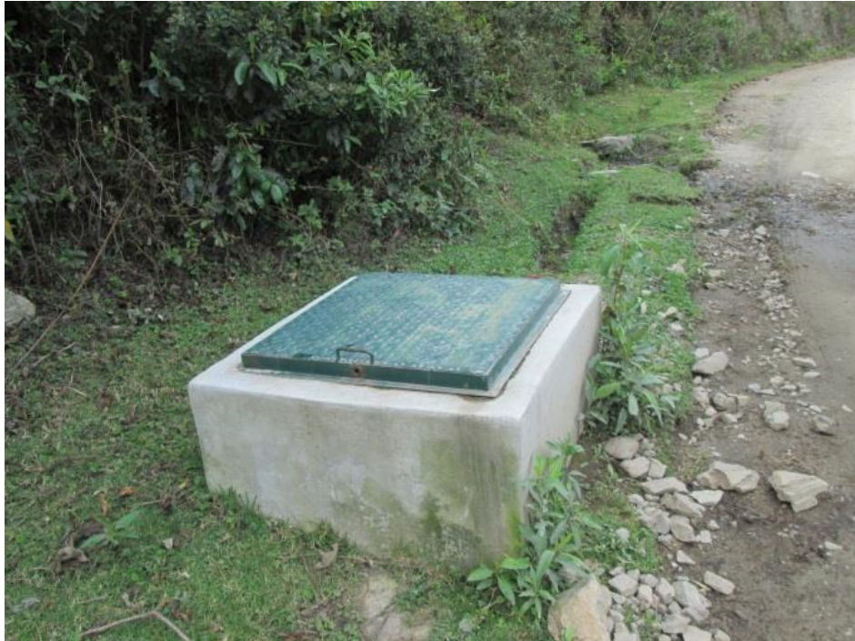
FUENTE: Elaboración propia. Cámara rompe presión típica en buen estado de conservación.
