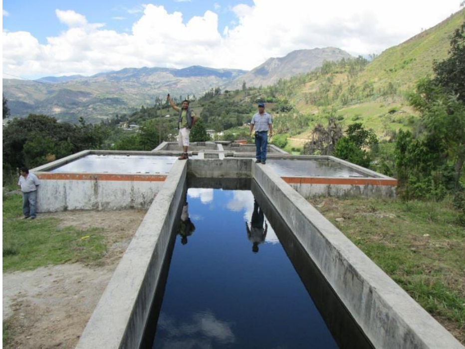
FUENTE: Elaboración propia. Planta de Tratamiento de agua potable de la Localidad de Sondor.
