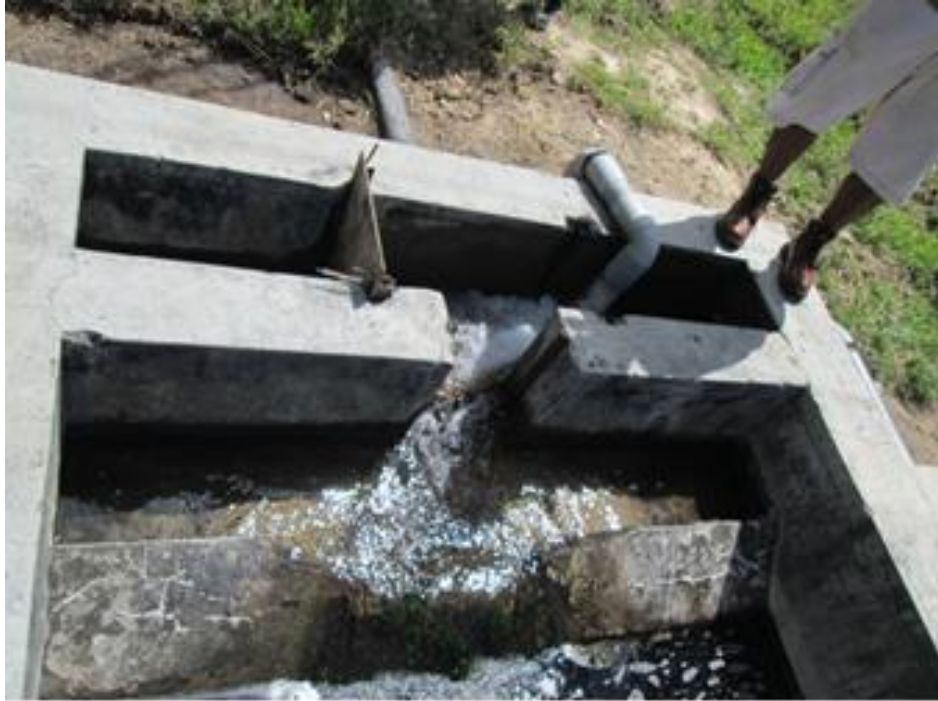
FUENTE: Elaboración propia. Llegada de línea de conducción de agua potable hacia la planta de tratamiento de agua potable de la Localidad de Sondor
