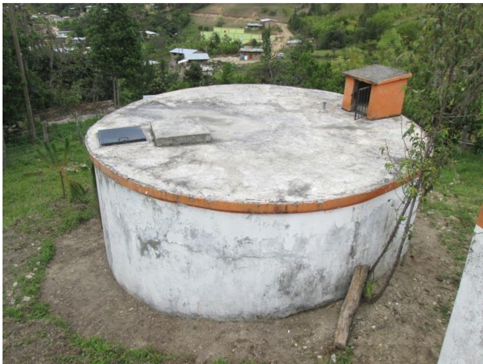
FUENTE: Elaboración propia. Reservorio Apoyado existente en la Localidad de Sondor
