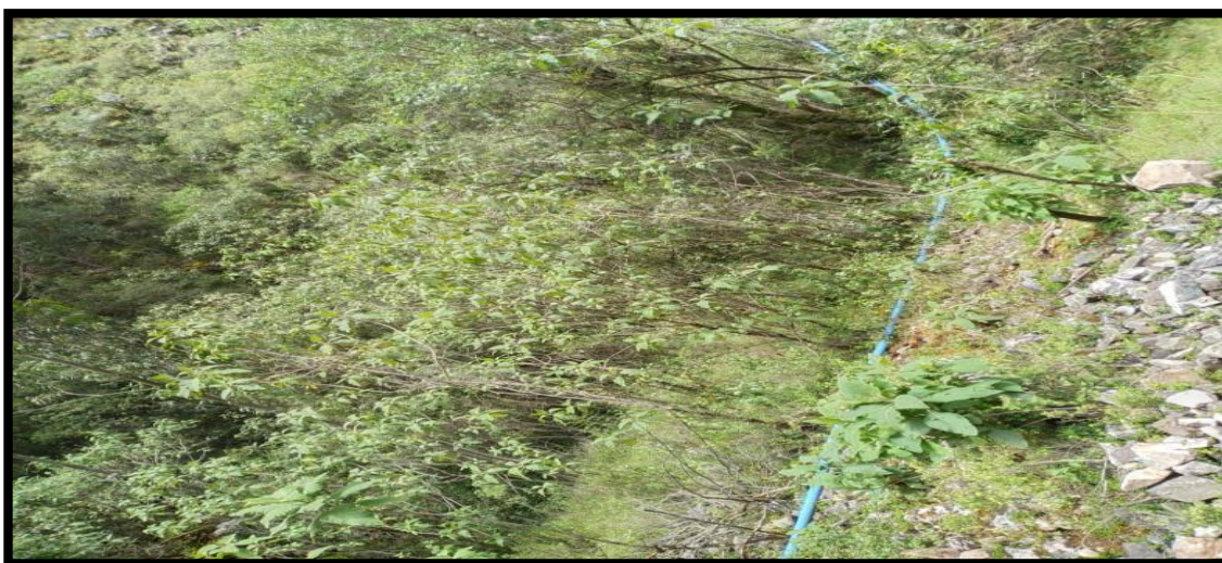
Se verifico que un tramo de 45 metros de la línea de conducción se encuentra expuestaa la intemperie, pero en un buen estado.
