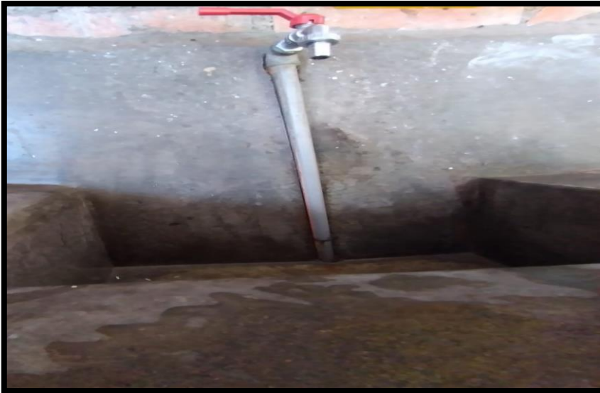
Fotografía 06: Cañerías en las viviendas.
