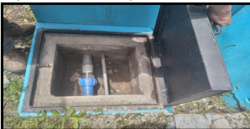
Fotografía 04: oxidación en las tapas metálicas.
