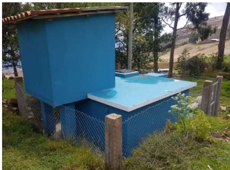
Imagen 14: se observa la captación el reservorio de almacenamiento del centro poblado Granero, distrito de Jesús, provincia de Cajamarca, departamento de Cajamarca.
