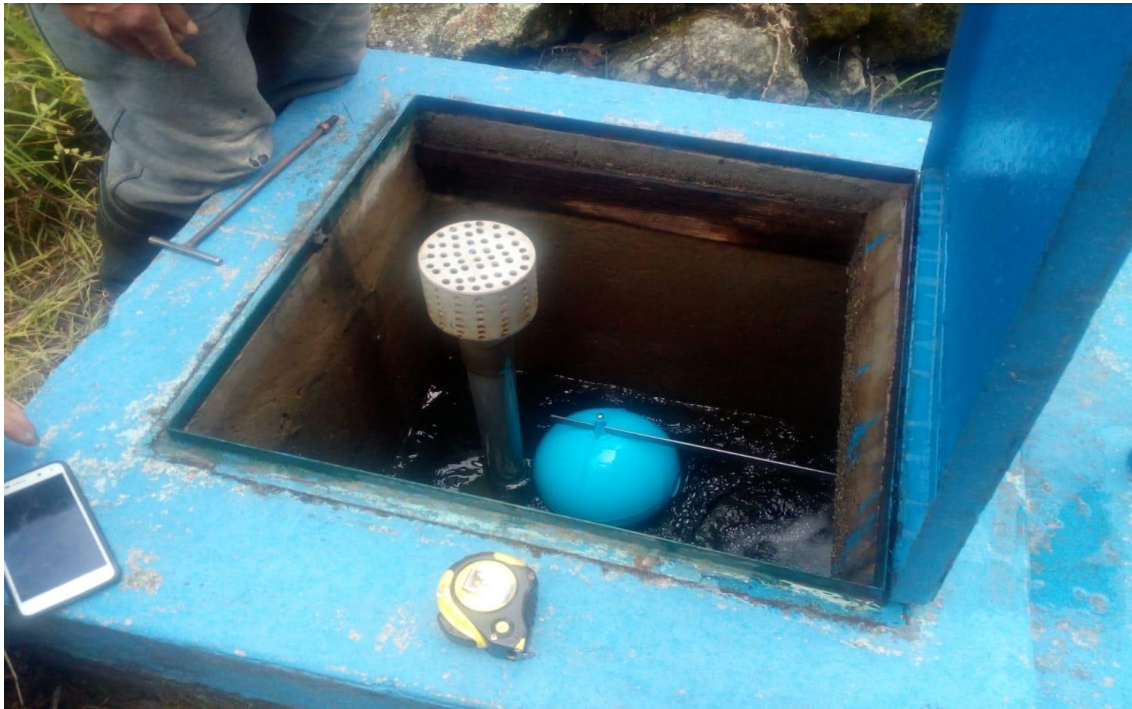
Figura 55. Cámara Rompe Presión - Visita de campo al sistema de saneamiento básico Fuente. Elaboración propia – 2020
