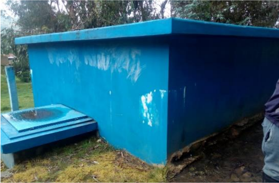
Figura 45. Reservorio 1 - Visita de campo al sistema de saneamiento básico Fuente. Elaboración propia – 2020
