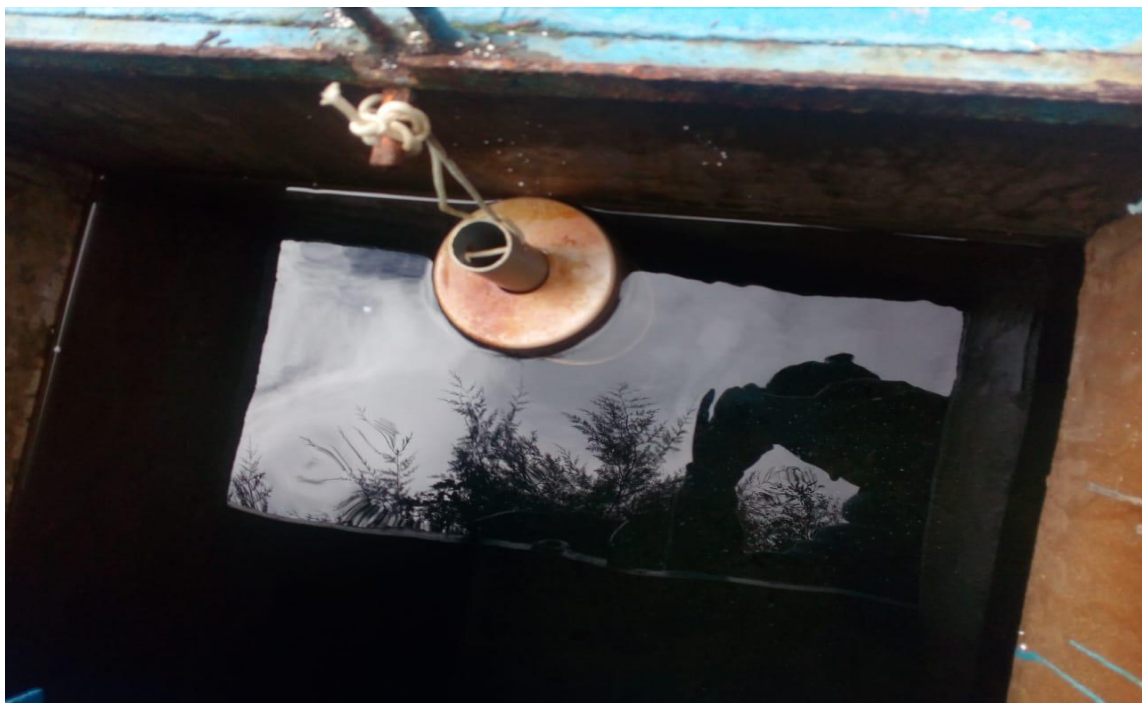
Figura 54. Reservorio - Visita de campo al sistema de saneamiento básico Fuente. Elaboración propia – 2020
