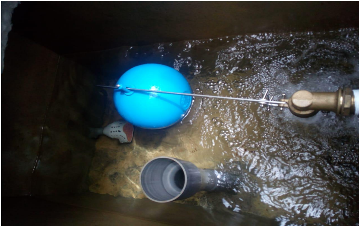
Figura 53. Cámara Rompe Presión - Visita de campo al sistema de saneamiento básico Fuente. Elaboración propia – 2020
