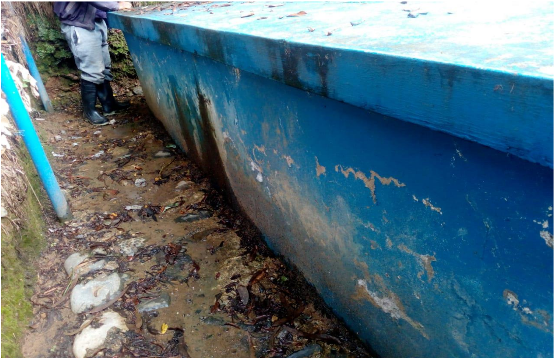
Figura 62. Reservorio - Visita de campo al sistema de saneamiento básico Fuente. Elaboración propia – 2020
