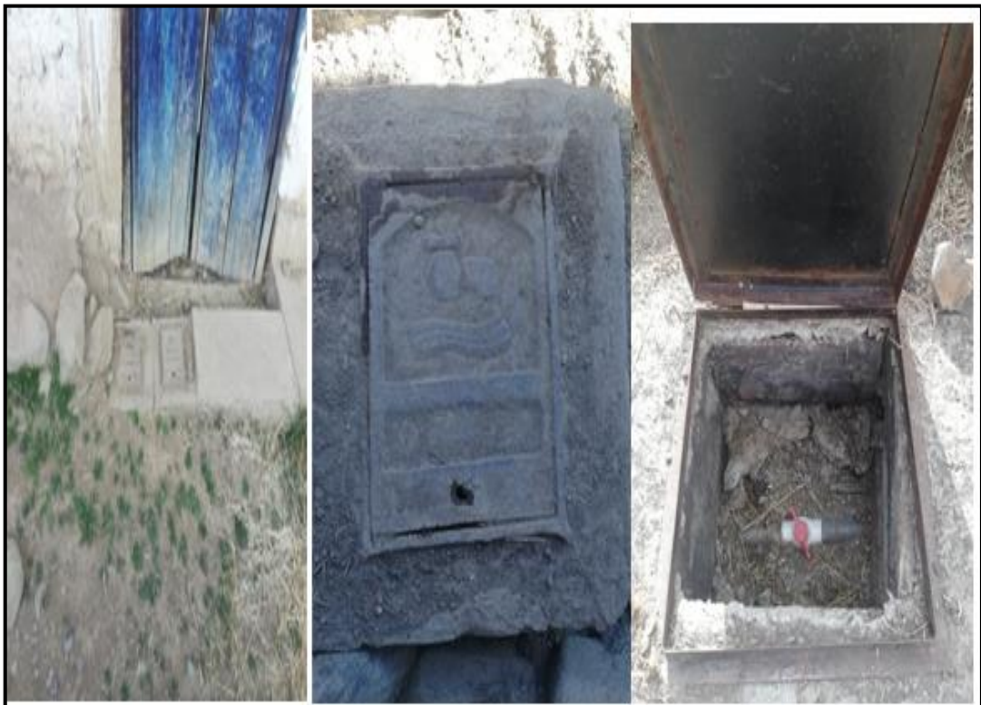
Fotografía 14. Llaves de paso.
