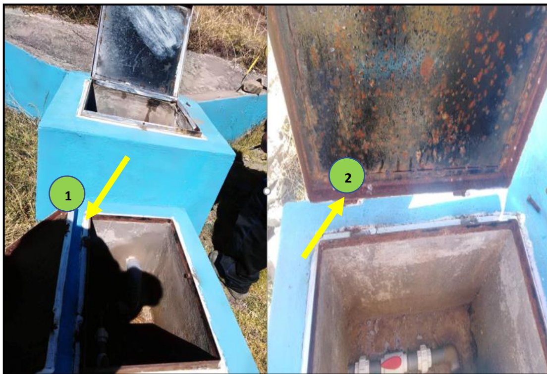
Fotografía 5.Desprendimiento de tornillos (1) y oxidación en la tapa de la caja de válvulas (2) de la captación.
