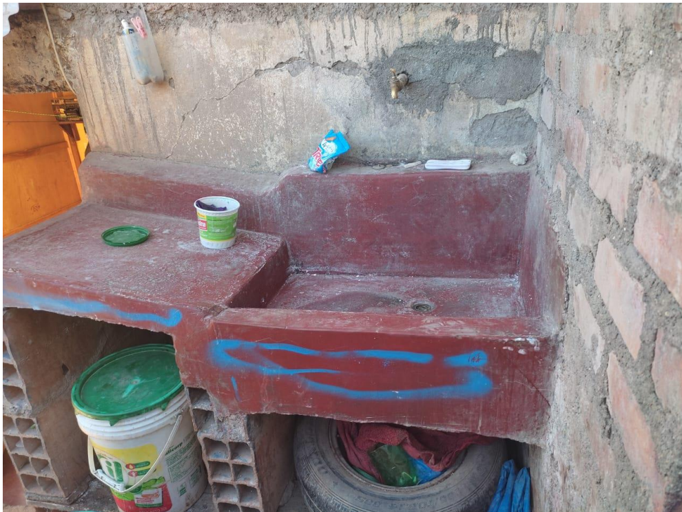
Figura 12: Conexión domiciliaria de una vivienda.
