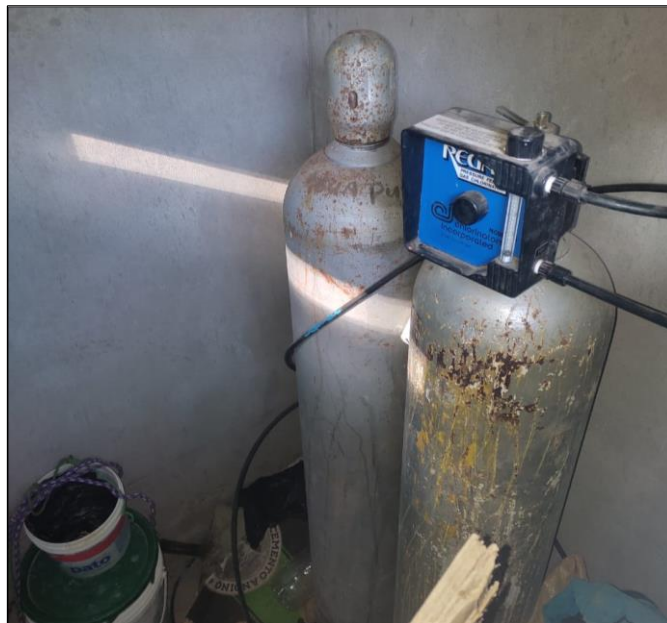
Figura 5: Caseta de cloración del reservorio del Sector Itana Waycco. Fuente: Elaboración propia.
