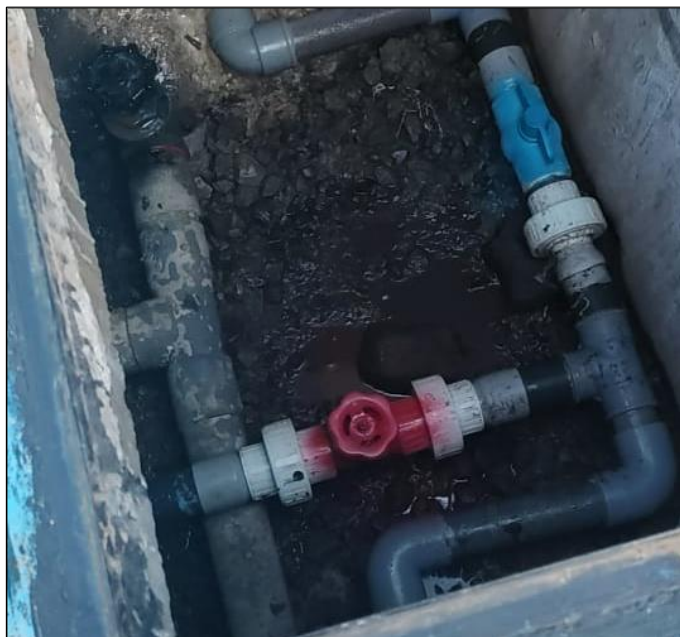
Figura 6: Caseta de válvulas del reservorio del Sector Itana Waycco. Fuente: Elaboración propia.
