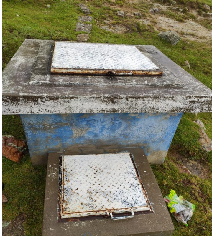
Fotografía N° 07: CUARTA CÁMARA ROMPE PRESIÓN (CR-6) DE ANTAPURHUAY
