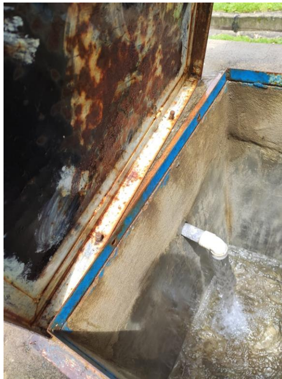
Fotografía N° 04: SEXTA CÁMARA EN MALAS CONDICIONES DE ANTAPURHUAY
