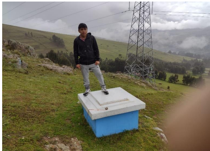
Fotografía N° 08: TERCERA CÁMARA ROMPE PRESIÓN (CR-7)
