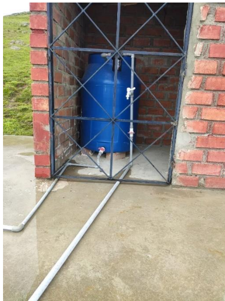
Fotografía N° 06: ALMACENAMIENTO Y SANEAMIENTO DEL AGUA DE YANAMITO
