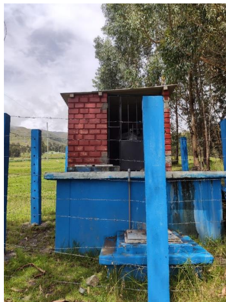
Fotografía N° 02: ALMACENAMIENTO Y SANEAMIENTO DEL AGUA DE ANTAPURHUAY
