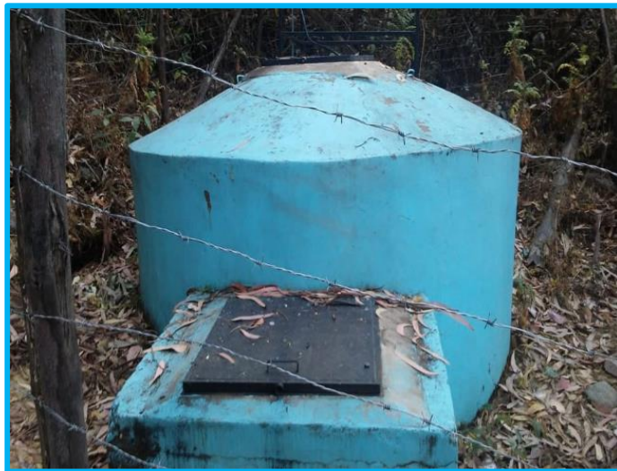
Figura 19: Vista del reservorio de almacenamiento
