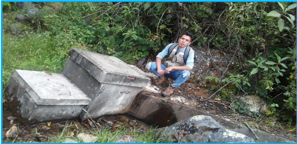
Figura 14: Vista completa de la fuente de manantial y la cámara de captación
