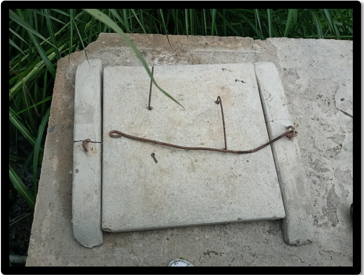
Fotografía 03: se visualiza la estructura con patologías.
