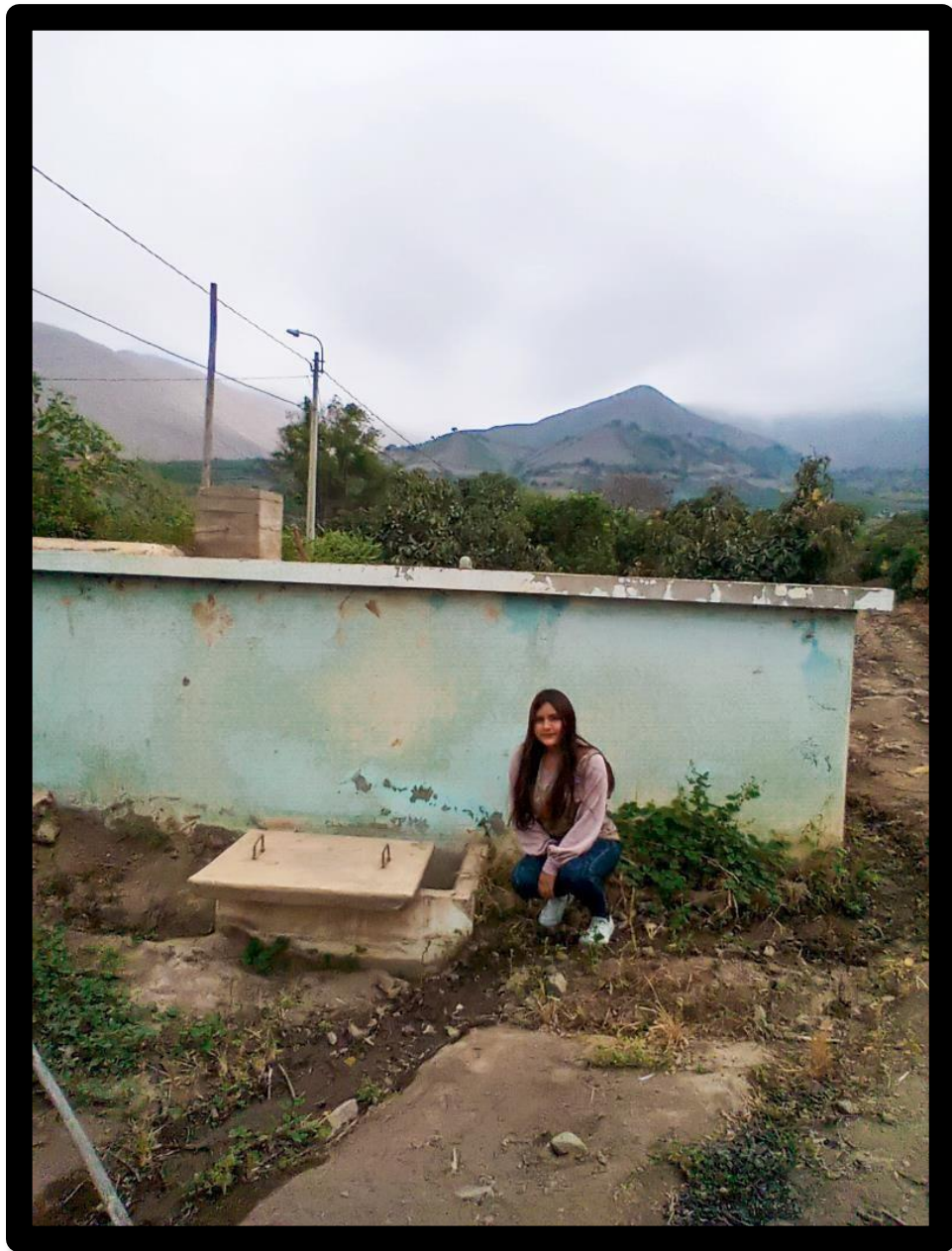
Fotografía 04: Reservorio existente con patologías de eflorescencia y fisuras en la estructura.
