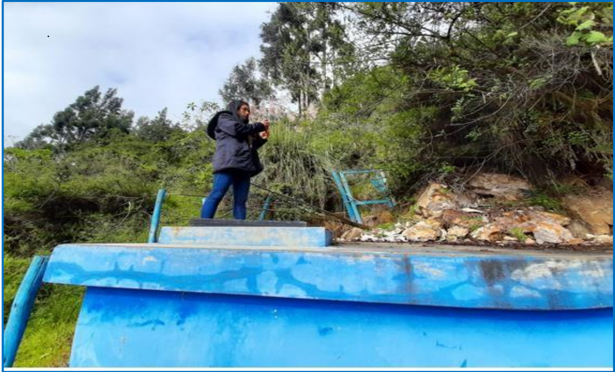
FOTOGRAFIA N° 3. DERRUMBE SOBRE EL RESERVORIO DEL SISTEMA DE AGUA POTABLE DEL CASERIO DE COLLANA
