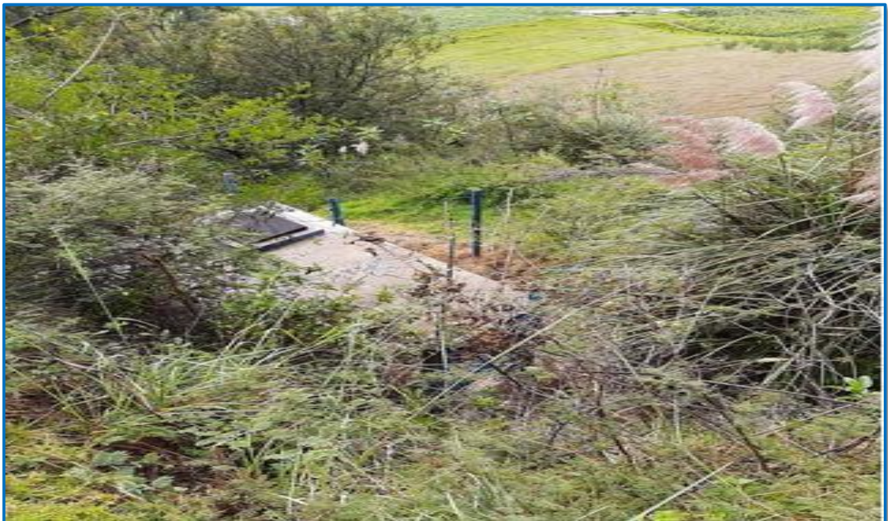
FOTOGRAFIA N° 4. FALTA DE MANTENIMIENTO A LAS ESTRUCTURAS HIDRAULICAS QUE CONFORMAN EL SISTEMA DE AGUA DEL CASERIO DE COLLANA.
