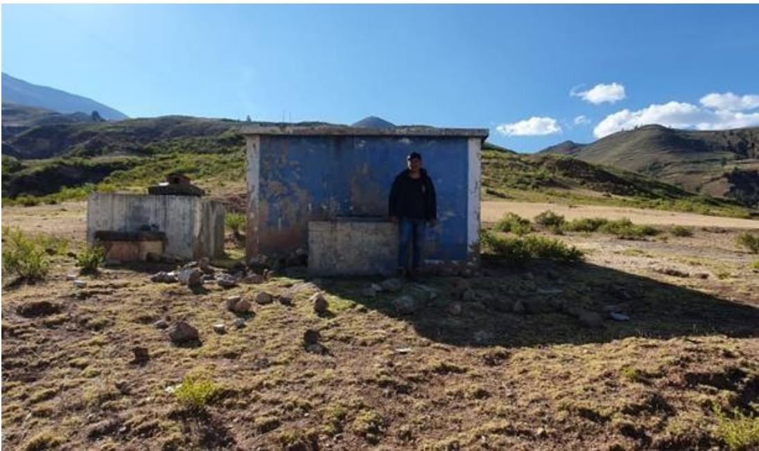
Imagen N° 04: Reservorio de almacenamiento de la localidad de Cashapampa, Distrito de Cashapampa, Provincia de Sihuas, Departamento de Áncash – 2022.
