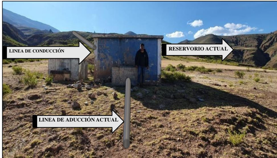
Figura 13: Estado de reservorio de almacenamiento.
