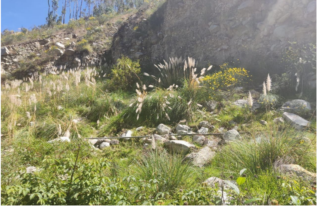
Imagen 12 Línea de conducción
