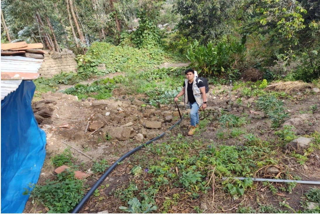
Imagen 13. Línea de aducción
