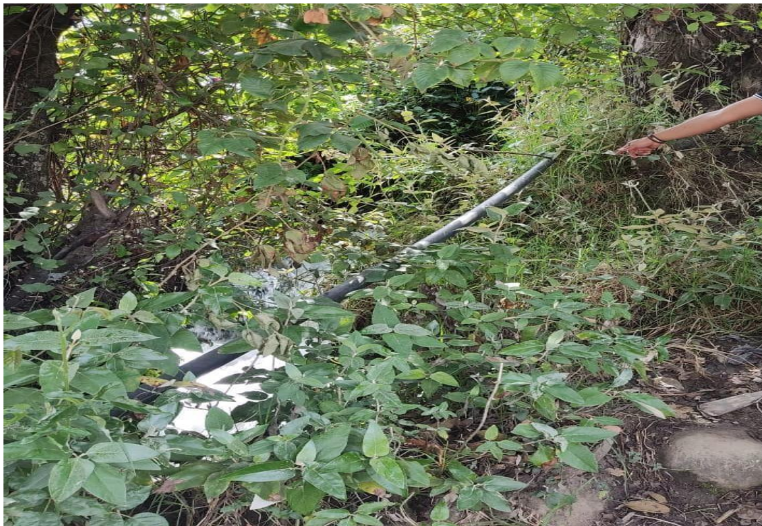
Imagen 6 Línea de aducción
