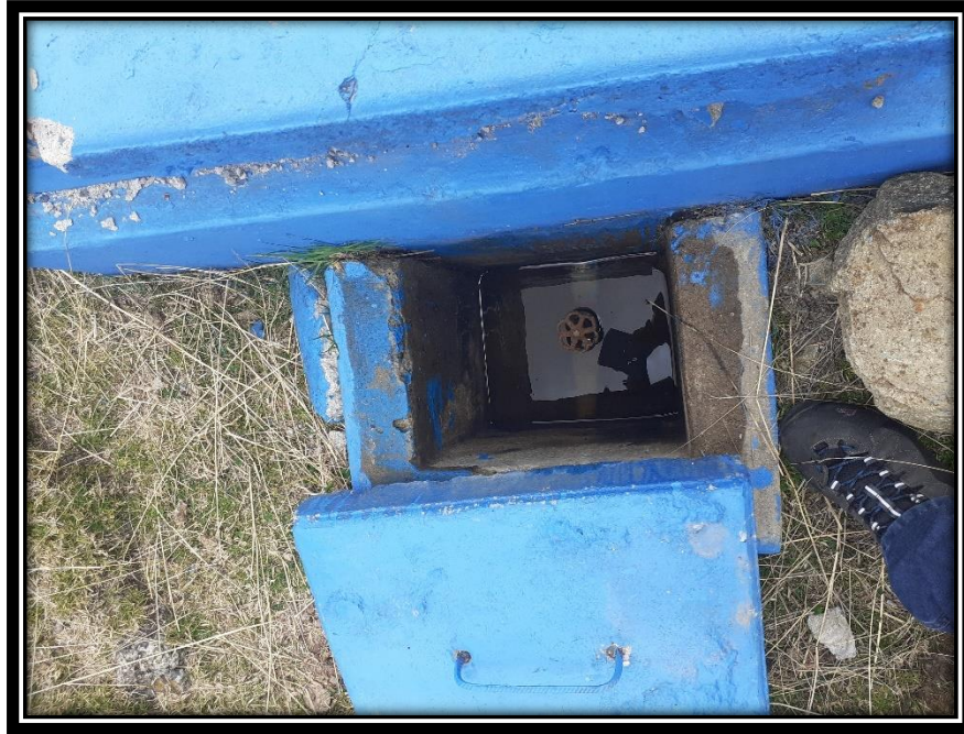
FOTOGRAFÍA N° 04. -caseta de válvula de la cámara rompe presión tipo – VI en funcionamiento.
