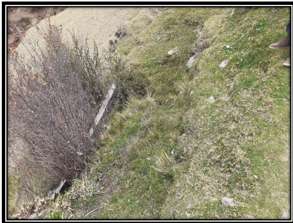
FOTOGRAFÍA N° 07.- tramo afectado de la línea de conducción.
