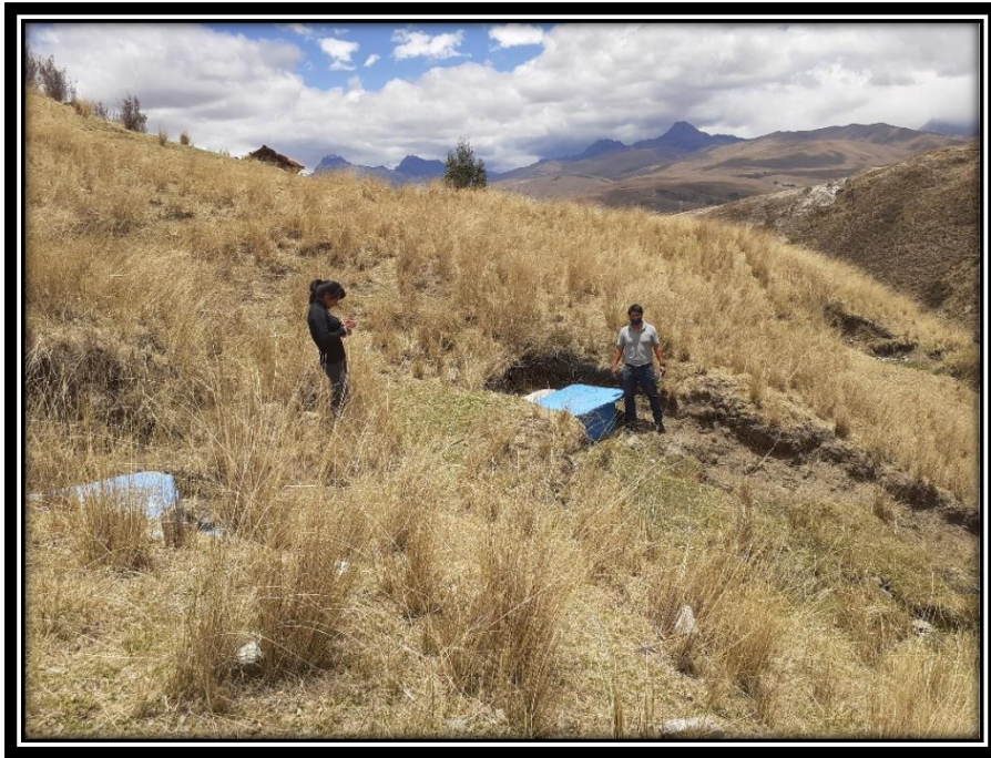
FOTOGRAFIA N° 02.- estado actual de la captación N°02, donde no se aprecia cerco perimétrico actual.
