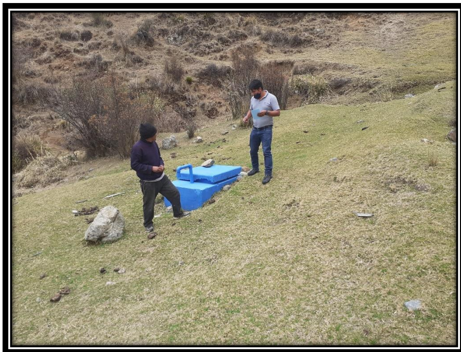
FOTOGRAFIA N° 03.- cámara rompe presión tipo – VI en funcionamiento.
