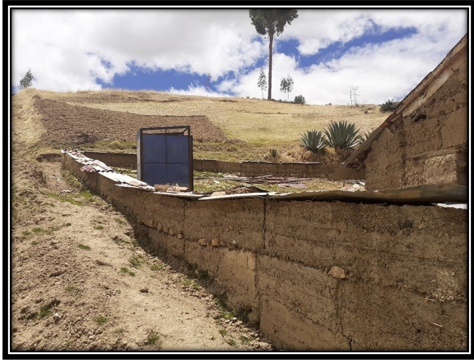
FOTOGRAFÍA N° 08. -letrina en mal estado sin techo y oxidado de usuario de Chuyan..
