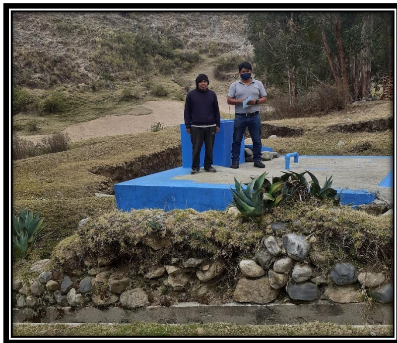
FOTOGRAFÍA N° 05. -Reservorio N°01 donde no se aprecia que posee el cerco perimétrico.
