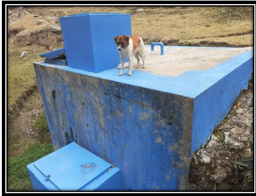
FOTOGRAFÍA N° 06.- Caseta de válvulas del reservorio N°01 y caseta de cloración en funcionamiento.
