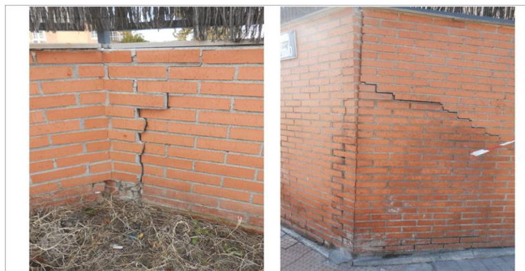
Figura 09. Patología en Muros de Albañilería
