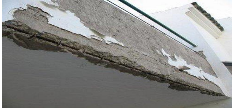
Figura 08. Patología del Concreto
