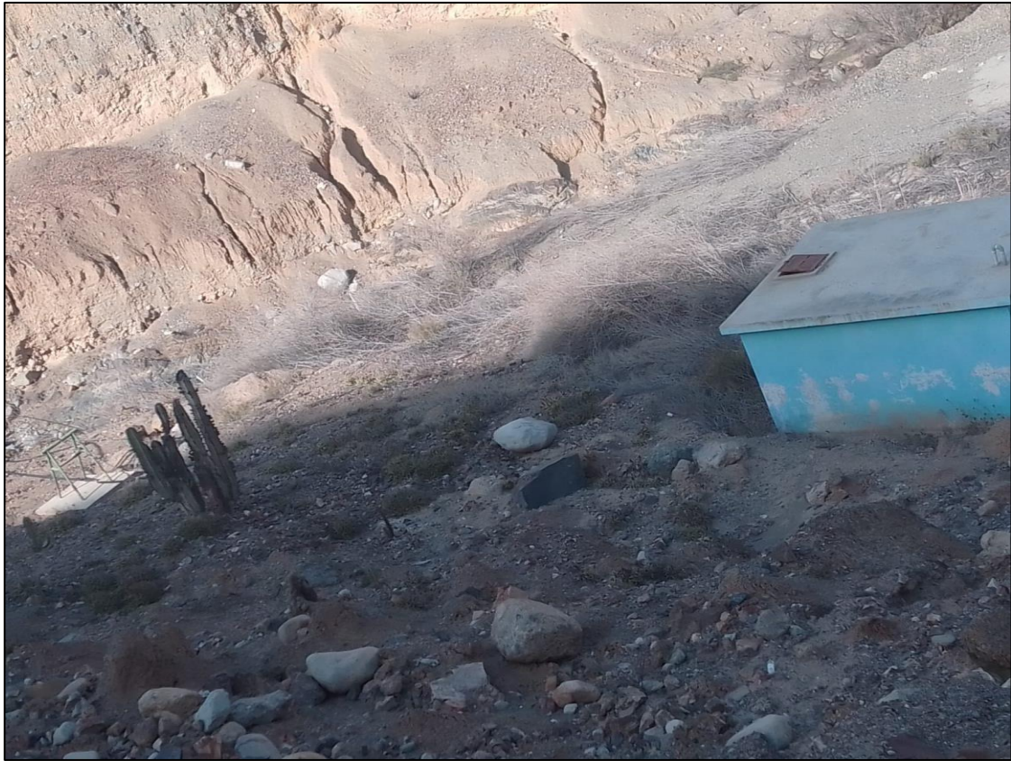
Imagen 12. Tubería de la línea de aducción.
