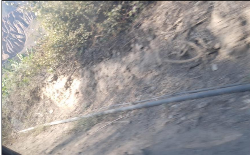
Imagen 10. Tubería de la línea de conducción.
