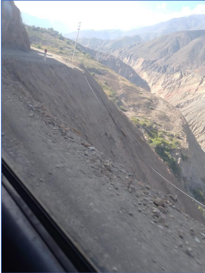
Imagen 2. Línea de conducción tramo 1
