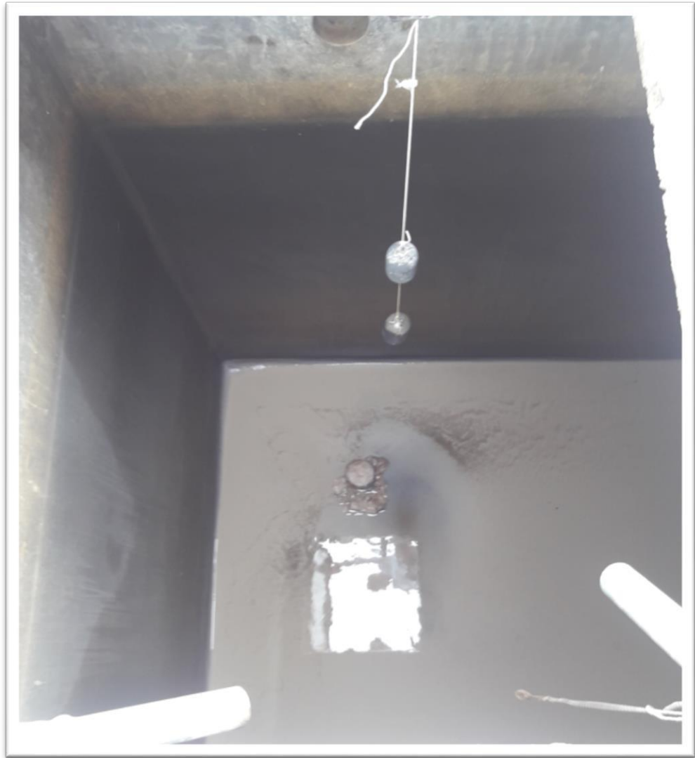
Fotografía 03: Tanque de almacenamiento del reservorio
