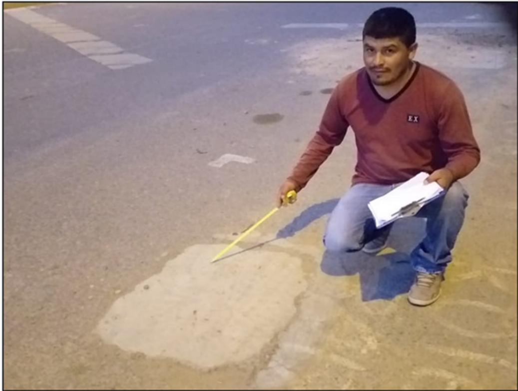
Fotografía 1: Vía con parche.
