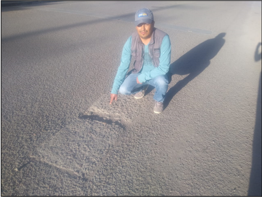
Fotografía 5: Vía con parche.
