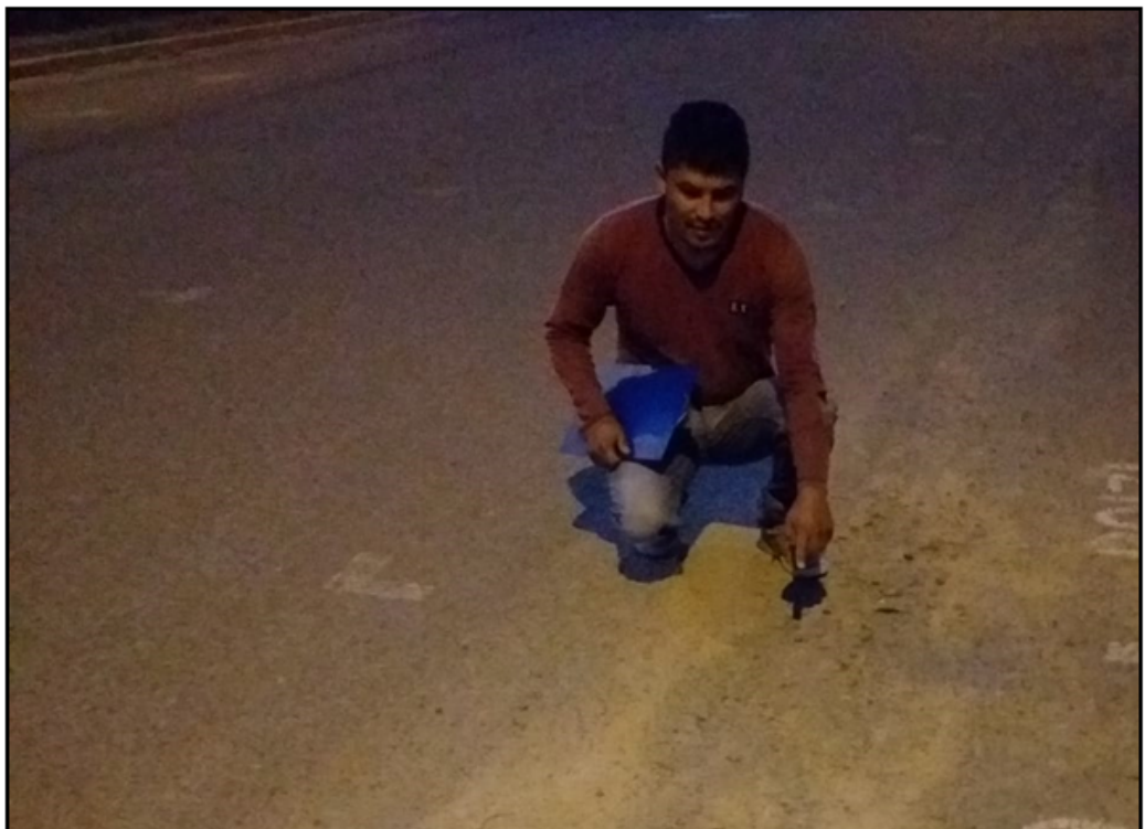
Fotografía 2: Vía con desprendimiento de agregados.
