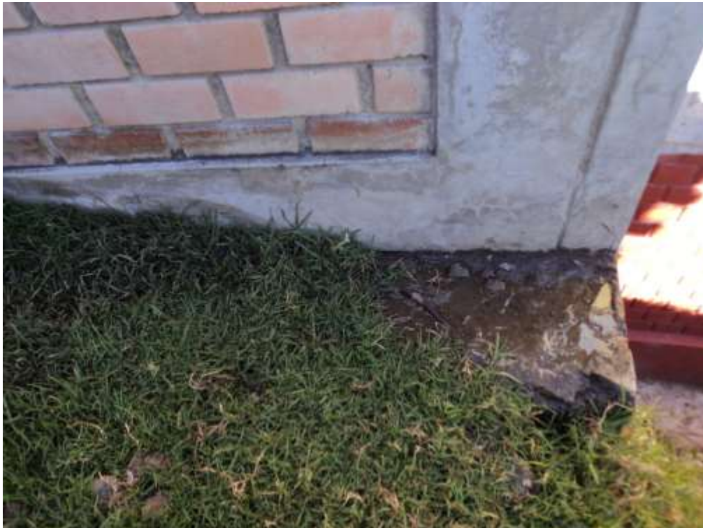
Presencia de humedad en el sobrecimiento
