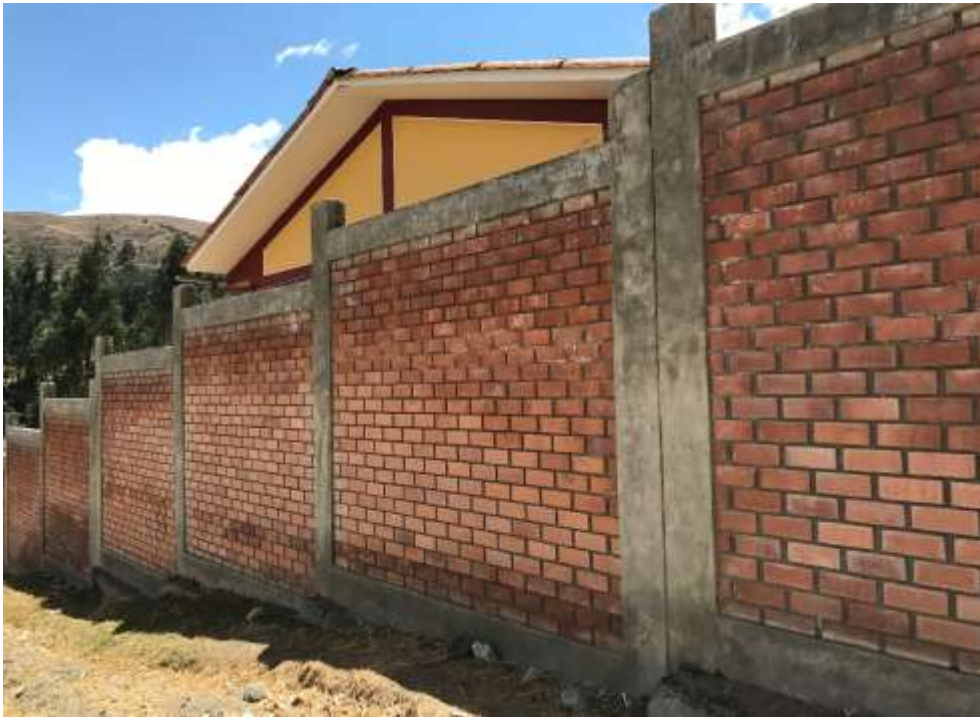
Presencia de eflorescencia en los muros
