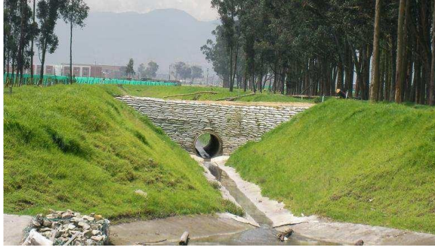
Figura 12 Capacidad hidráulica insuficiente en canales
