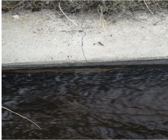
Imagen 29: Fisura en la pared del canal
