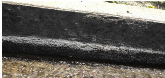
Imagen 30: Fisura en la pared del canal
