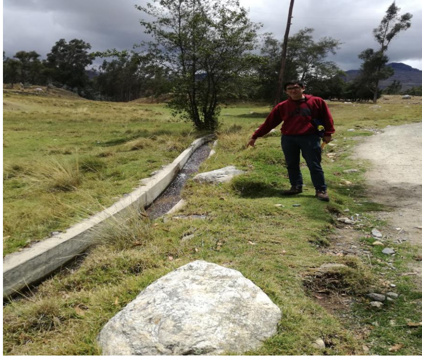
Imagen 35: Vista del Canal Yurac Yacu entre las progresivas 0+000 – 1+000 sector Cachipampa, se observa una grieta en el margen derecho.
