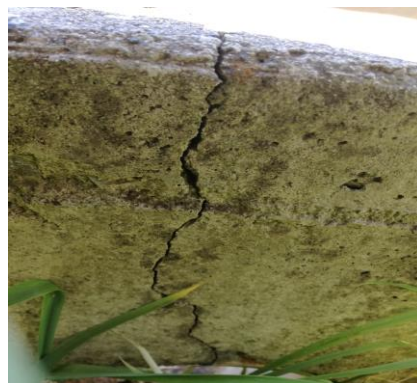
Imagen 28: Grieta en la pared del canal
