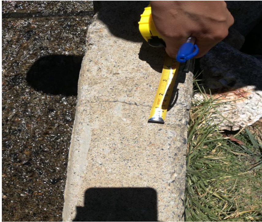
Imagen 36: Vista del Canal Yurac Yacu entre las progresivas 0+000 – 1+000 sector Cachipampa, se observa fisura en el margen derecho.
