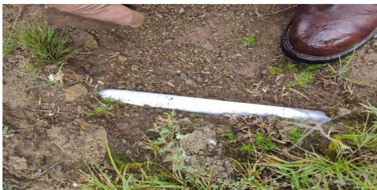
Figura N° 017: Línea de conducción
