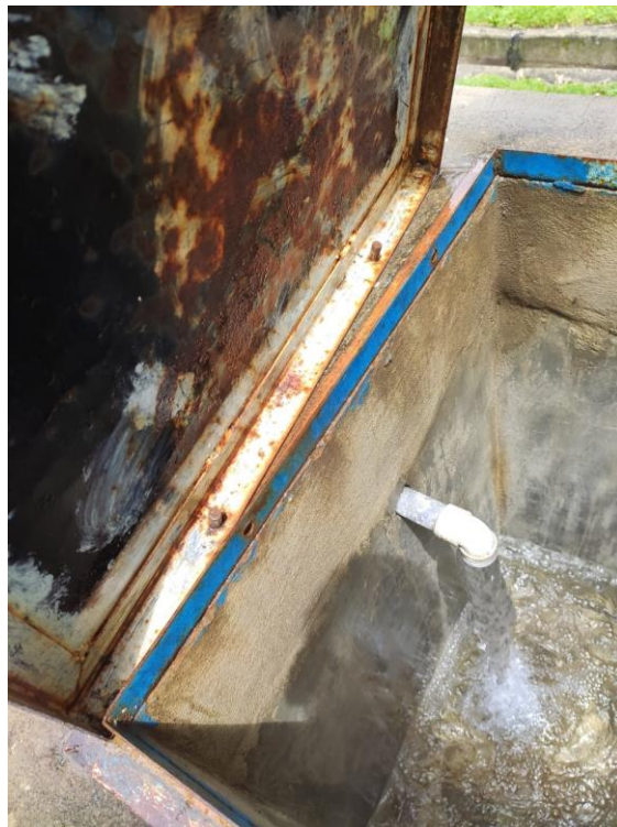
Fotografía N° 04: SEXTA CÁMARA EN MALAS CONDICIONES DE ANTAPURHUAY
