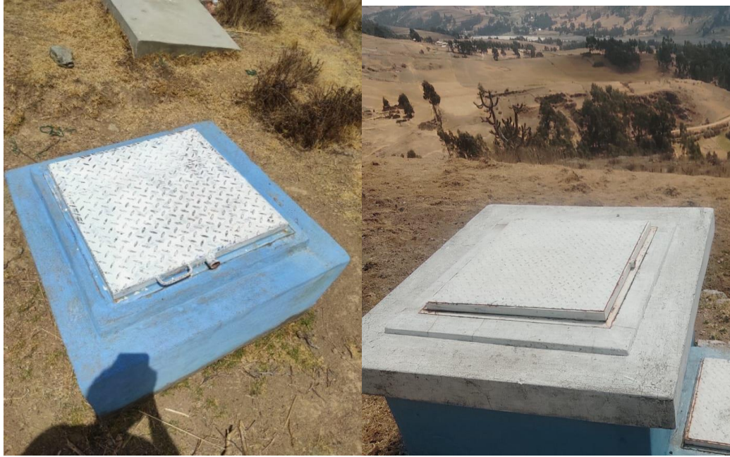
Figura N° 019: Cámaras rompe presión
