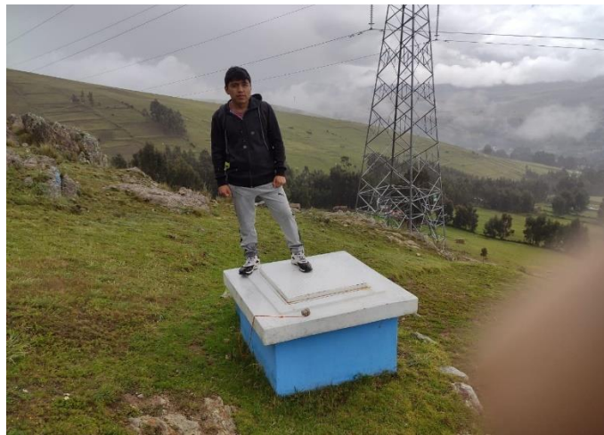
Fotografía N° 08: TERCERA CÁMARA ROMPE PRESIÓN (CR-7)
