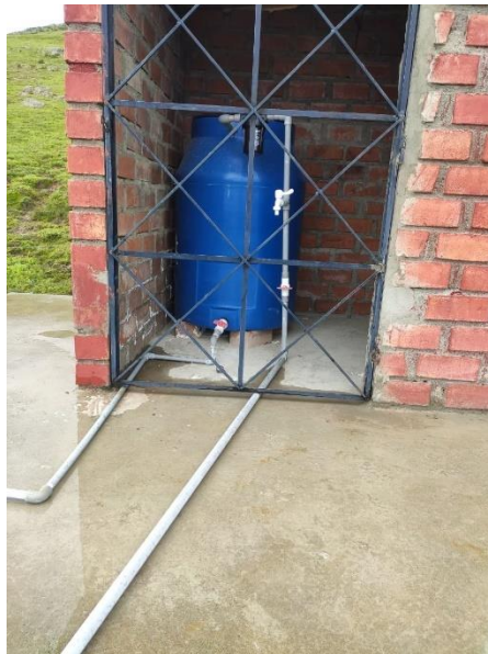
Fotografía N° 06: ALMACENAMIENTO Y SANEAMIENTO DEL AGUA DE YANAMITO
