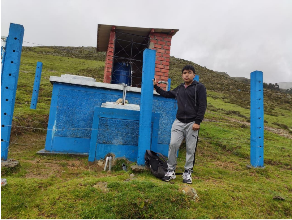
Fotografía N° 05: ALMACENAMIENTO Y SANEAMIENTO DEL AGUA DE YANAMITO
