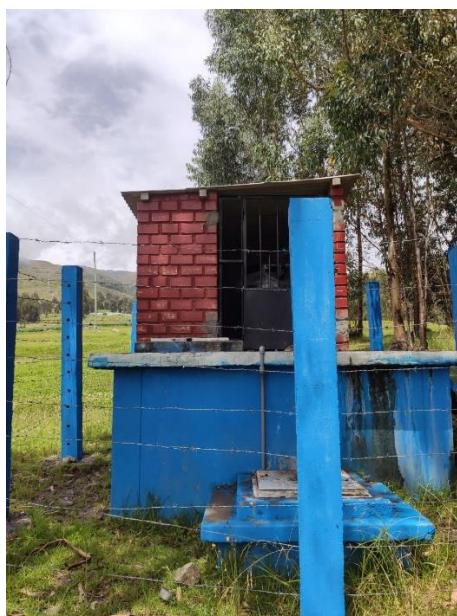
Fotografía N° 02: ALMACENAMIENTO Y SANEAMIENTO DEL AGUA DE ANTAPURHUAY
