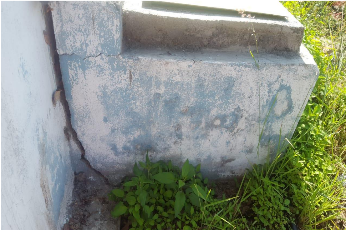
FOTO N° 7: PATOLOGIAS DEL CONCRETO. FISURAS Y AGRIETAMIENTOS
