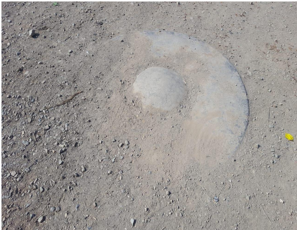
FOTO N° 8: SISTEMA DE ALCANTARILLADO. BUZONES TAPADOS
