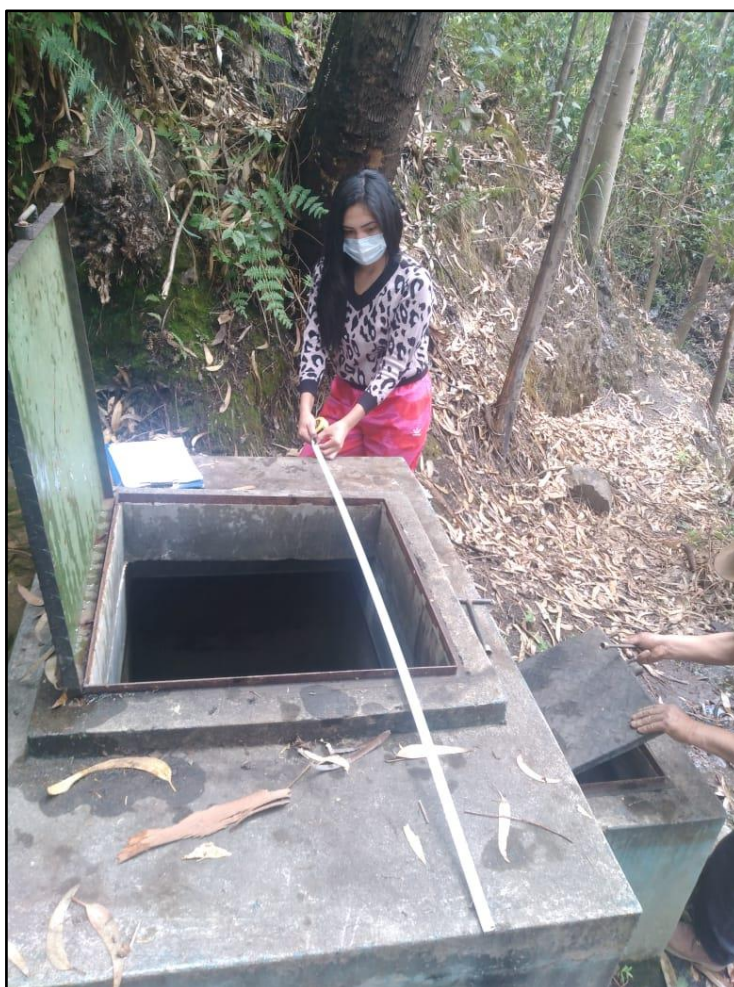
Foto 03: el tipo de captación es manantial de ladera
