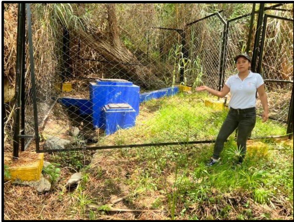
Figura 01: Captación, La fuente es subterránea y el tipo de captación es manantial de ladera
