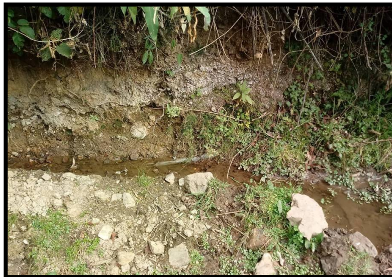
Imagen 7. línea de aducción de 1" expuesta.
