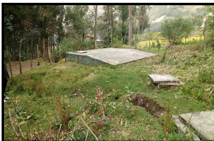
Imagen 5. Reservorio de almacenamiento existente.
