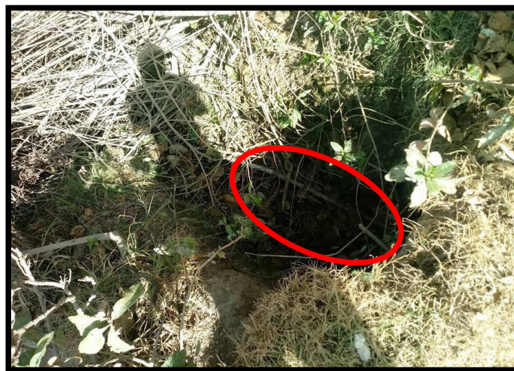
Imagen 4. Línea de conducción expuesta, progresiva 0+020.
