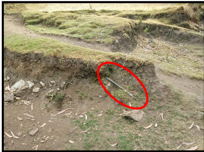
Imagen 3. Línea de conducción expuesta, progresiva 0+120.
