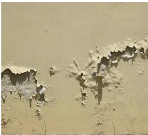
Imagen 12: Desconchamiento de pintura en muro de concreto.
