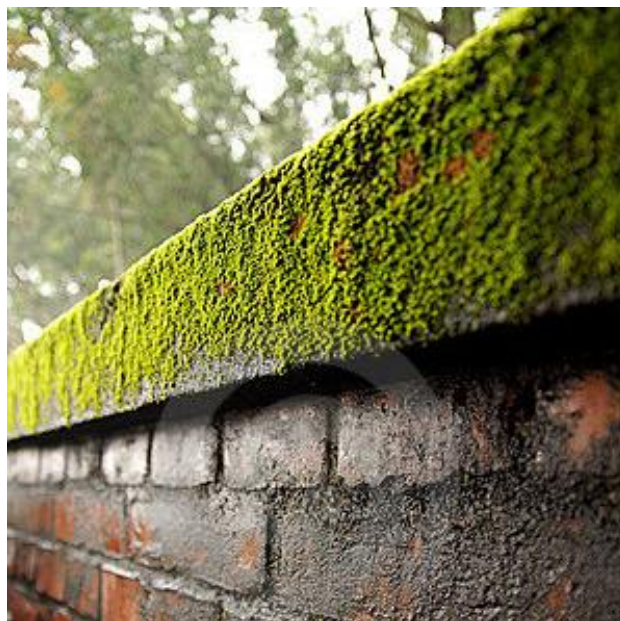
Imagen 20: Liquen en muro de albañilería.
