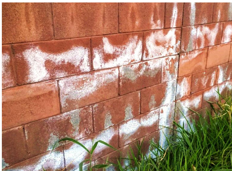
Imagen 18: Eflorescencia en muro de albañilería.
