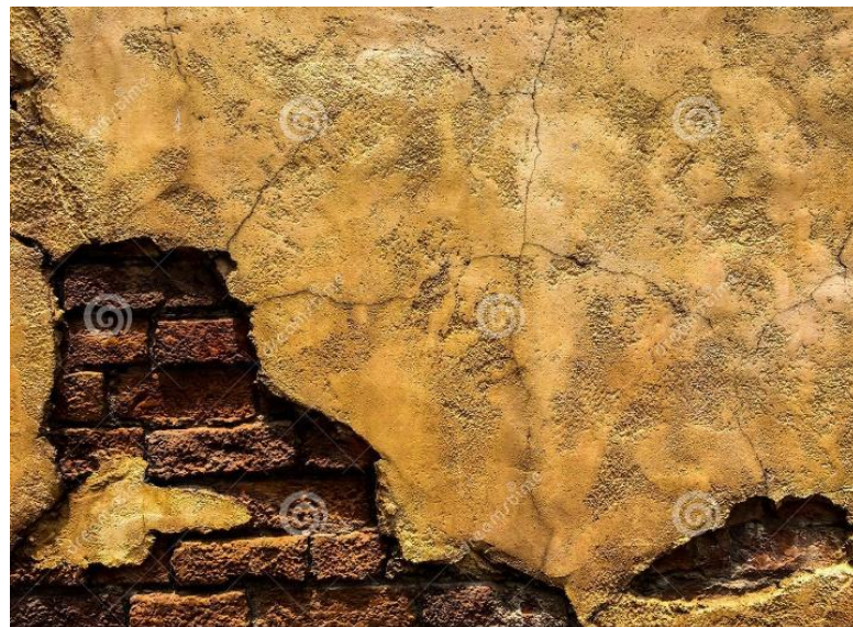
Imagen 17: Desprendimiento en muro de albañilería.
