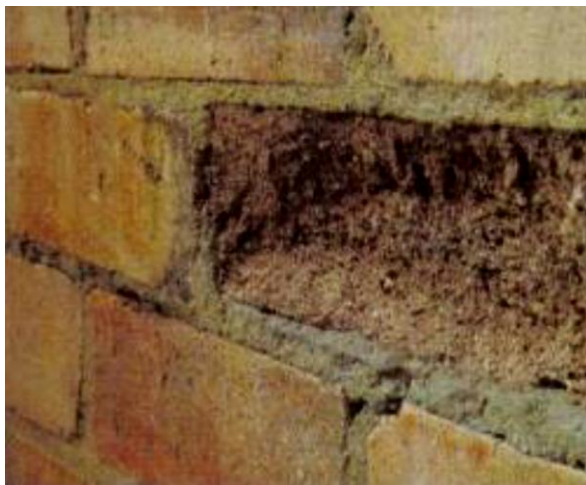
Imagen 13: Erosión Física en muro de albañilería.
