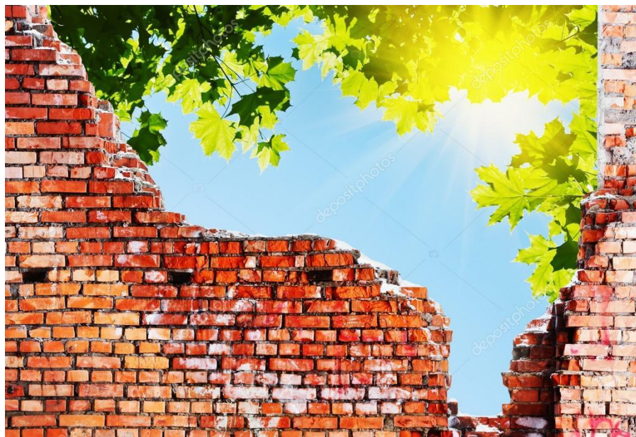
Imagen 16: Erosión Mecánica en muro de albañilería.
