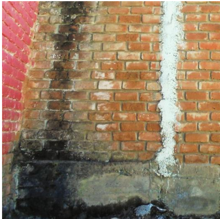
Imagen 22: Erosión Química en muro de albañilería.
