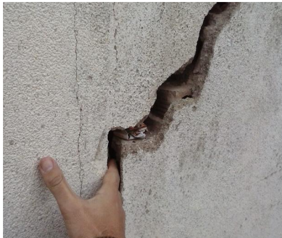
Imagen 15: Grieta en muro de albañilería.
