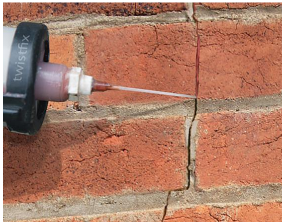
Imagen 14: Fisura en muro de albañilería.
