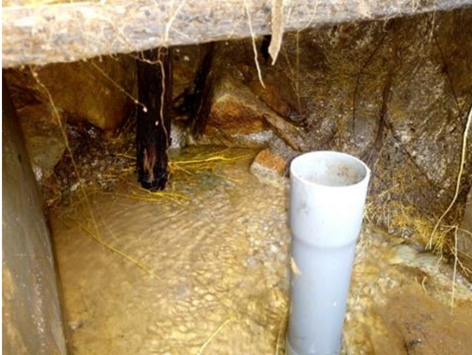
Figura 16. Muestra de filtración de agua
