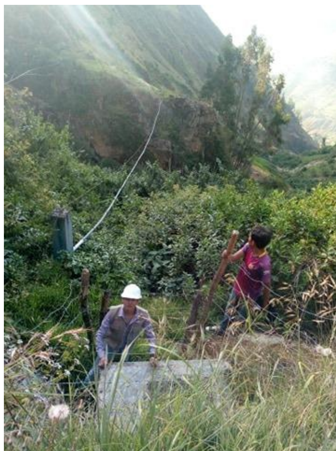
Figura 19. Línea de conducción
