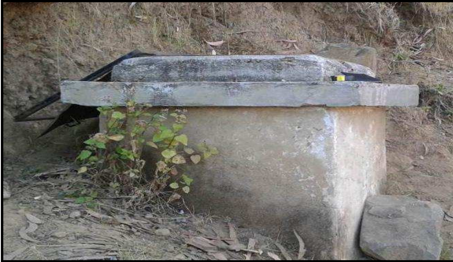
Imagen3: Cámara de rompe presión tipo CRP-06. La cámara no logra llenarse. El caudal que ingresa se pierde por deterioro de la losa de fondo.
