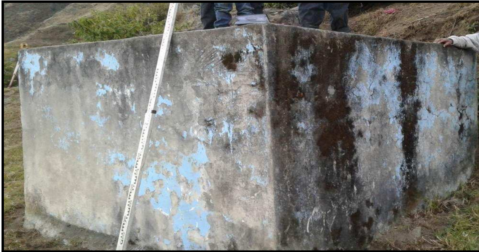
Imagen 5: Reservorio existente. La permeabilidad de las paredes y la losa de fondo impiden que el reservorio se llene y por ende, no abastezca a la población. Carece de caseta de válvulas y accesorios varios.
