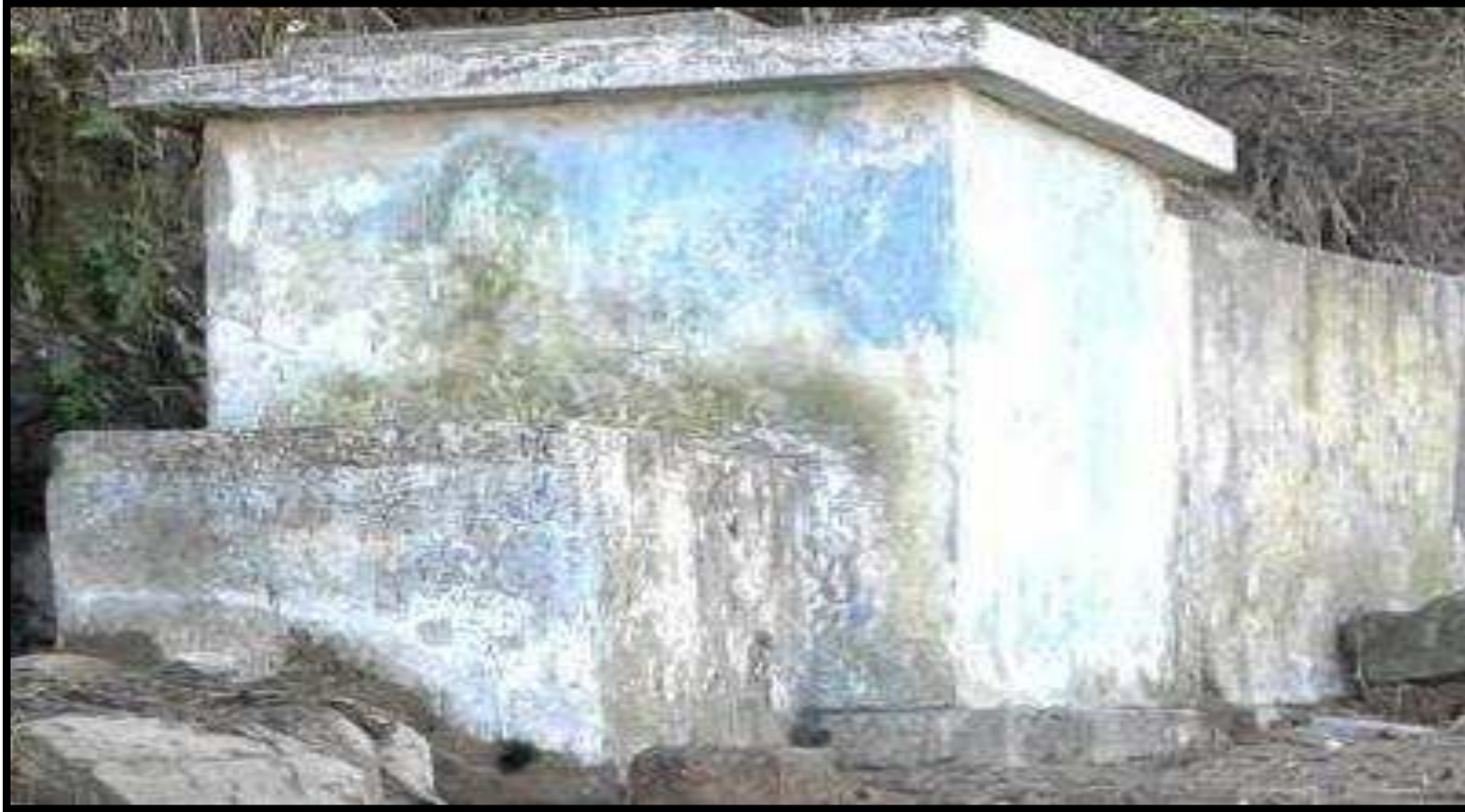
Imagen1: Captación existente. Se encuentra sobredimensionada para el caudal de demanda. Los muros han perdido permeabilidad y el agua se pierde a través de ellos, la losa de fondo se encuentra también en la misma situación.
