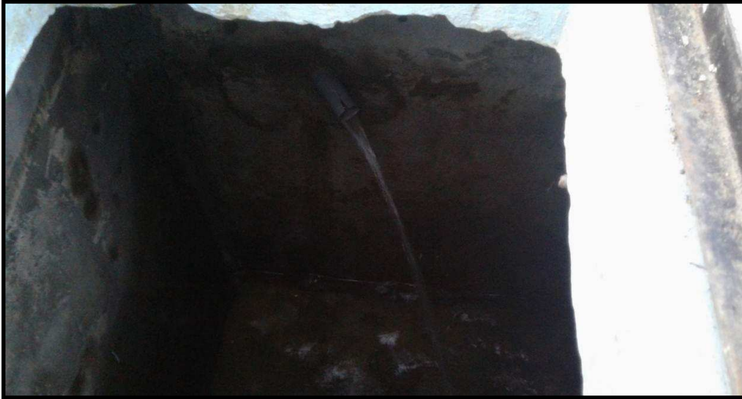
Imagen 6: Reservorio existente. La permeabilidad de las paredes y la losa de fondo impiden que el reservorio se llene y por ende, no abastezca a la población. Carece de caseta de válvulas y accesorios varios.
