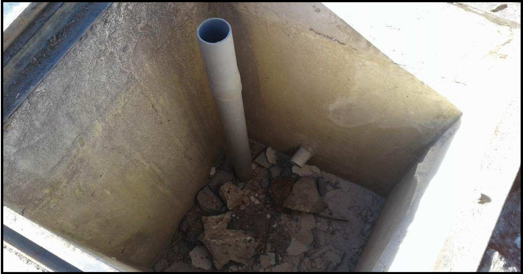
Imagen 8: Cámara de rompe presión tipo CRP – 07. Se encuentra en pésimo estado de conservación y en desuso. Le faltan todos sus accesorios.
