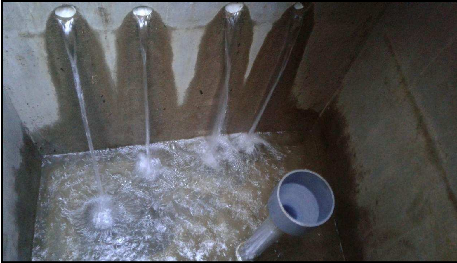
Imagen2: Captación existente. La cámara húmeda no logra llenarse. Los muros han perdido permeabilidad y el agua se pierde a través de ellos, la losa de fondo se encuentra también en la misma situación.
