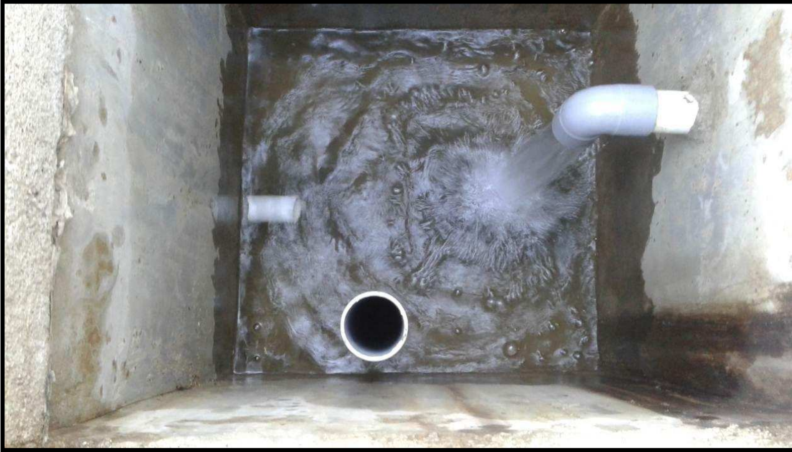
Imagen 4: Cámara de rompe presión tipo CRP-06. La cámara no logra llenarse. El caudal que ingresa se pierde por deterioro de la losa de fondo.
