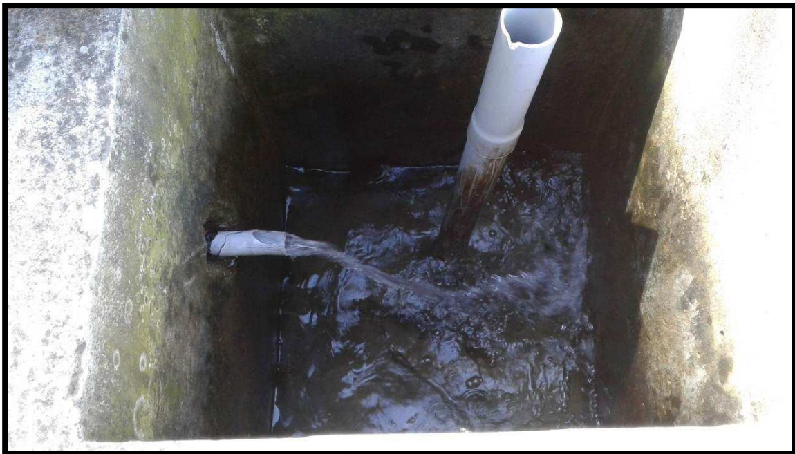
Imagen 3. Cámara rompe presión.
