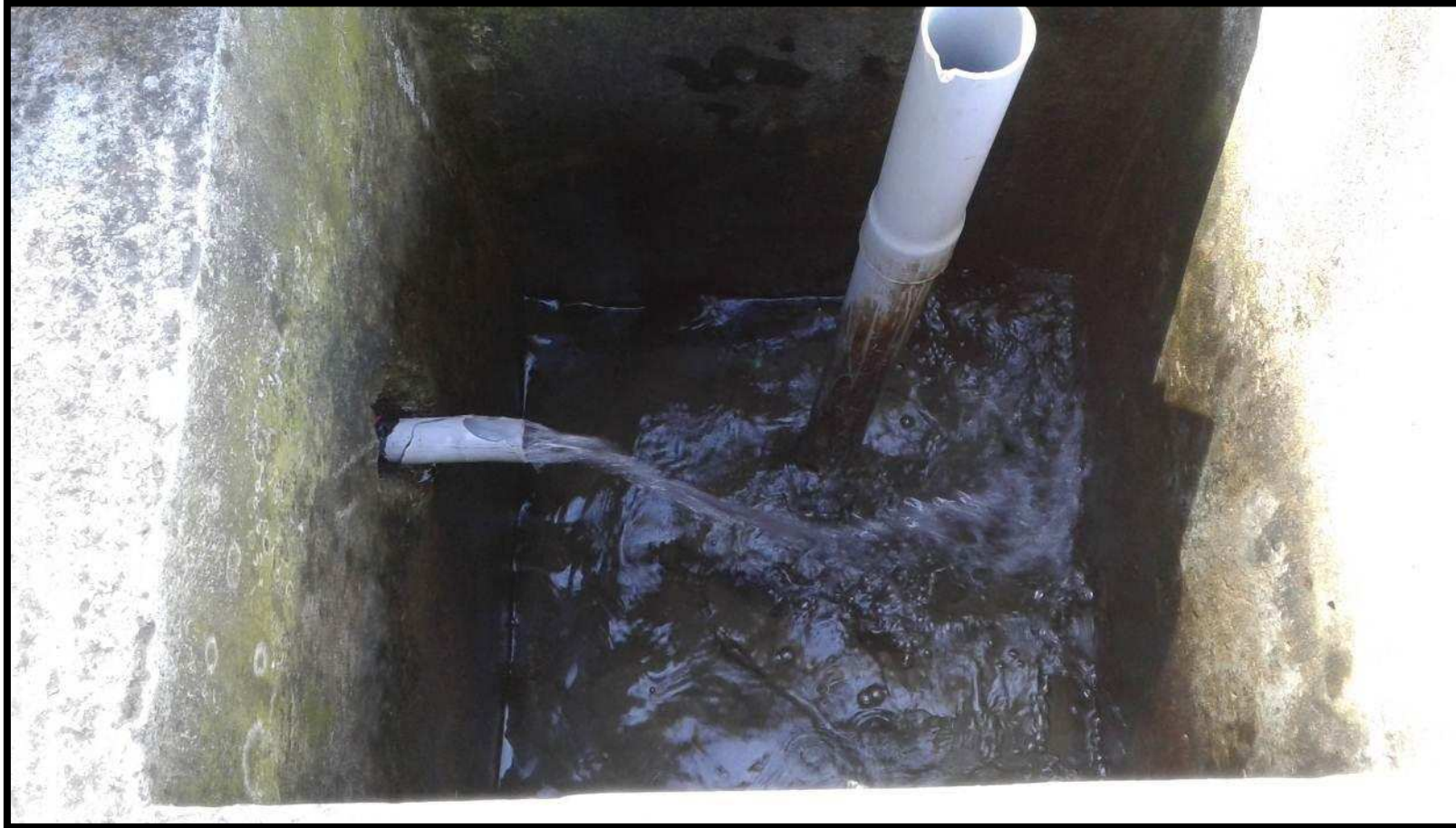
Imagen 9: Cámara de rompe presión tipo CRP – 07. Parcialmente operativa. Le faltan accesorios.
