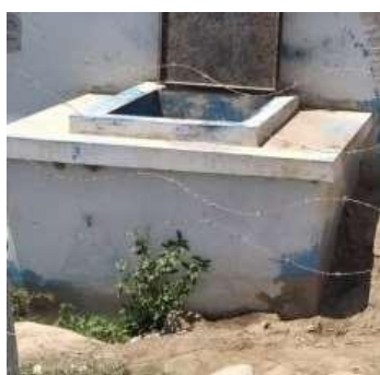
Figura 09. Caseta de válvulas
