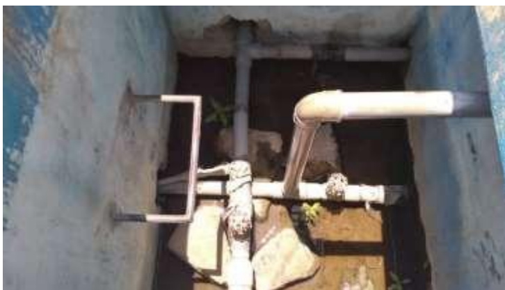
Imagen 2. Caseta de Válvulas
