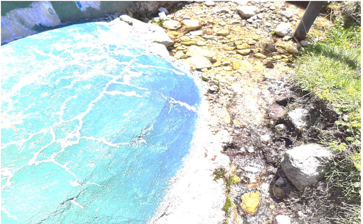
Fotografía 2 Captación principal, concreto agrietado, y hay filtraciones en tiempo de lluvias.
