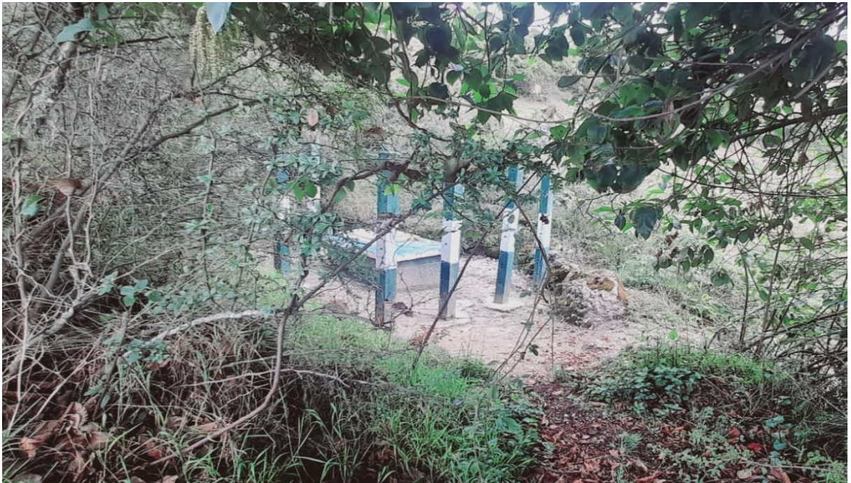
Fotografía 8 Cámara rompe presión.
