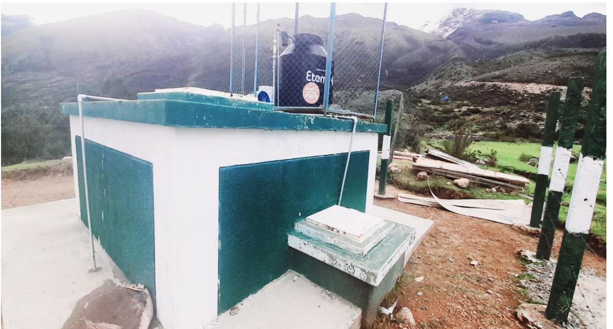
Fotografía 4 Reservorio (Se aprecia patologías).
