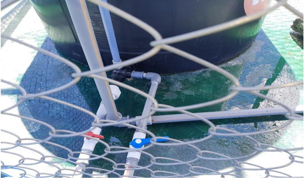
Fotografía 5 Fugas de agua en el reservorio.
