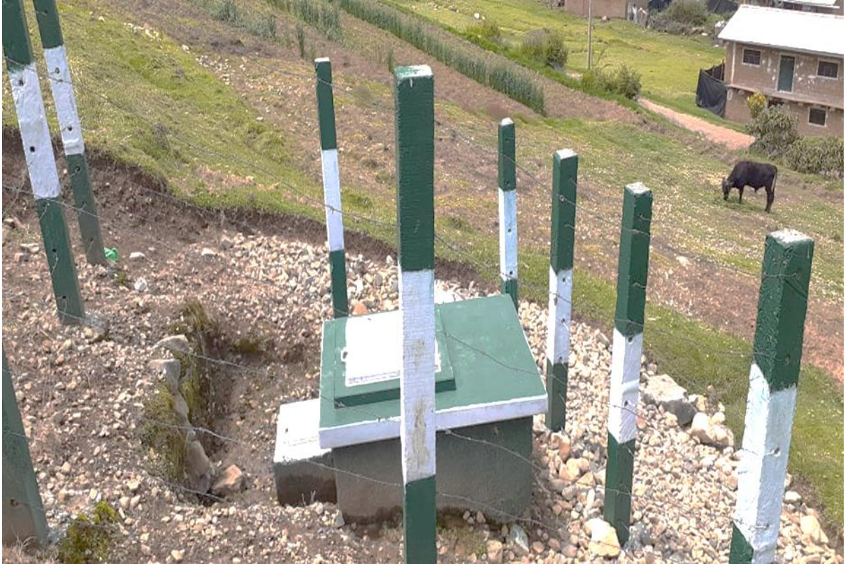
Fotografía 9 Cámara rompe presión.
