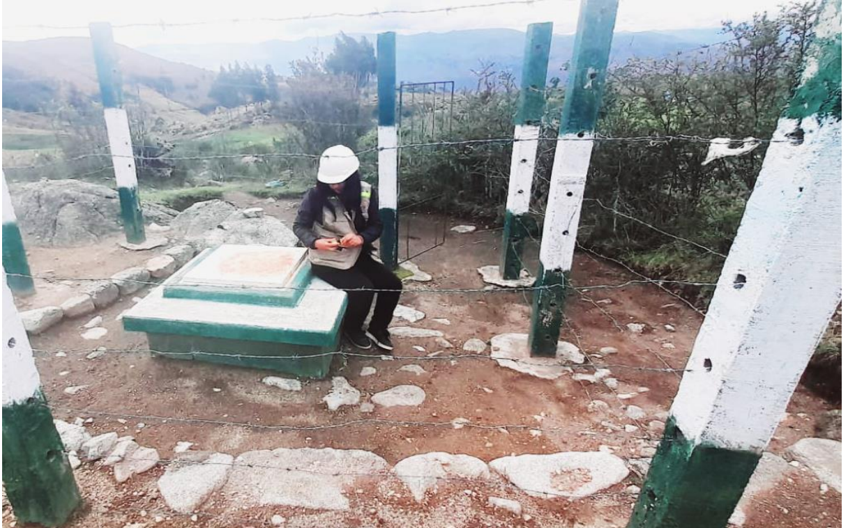
Fotografía 7 Cámara rompe presión.
