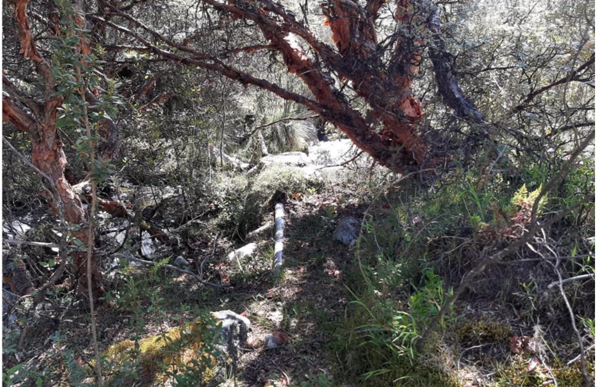
Fotografía 3 Línea de conducción, tubería expuesta.
