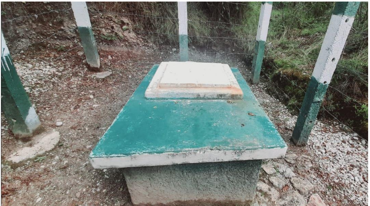
Fotografía 6 Cámara de romper presión.
