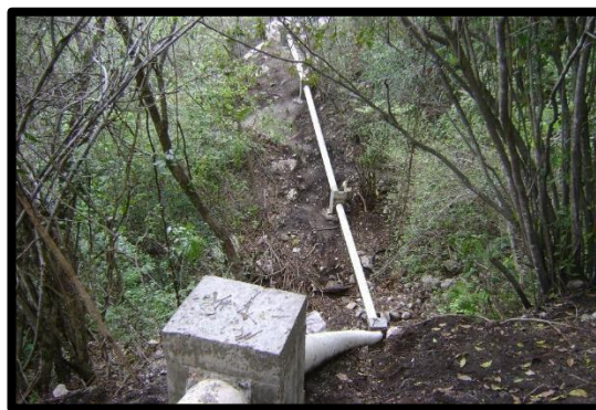
Imagen 14: Línea de conducción de agua potable
