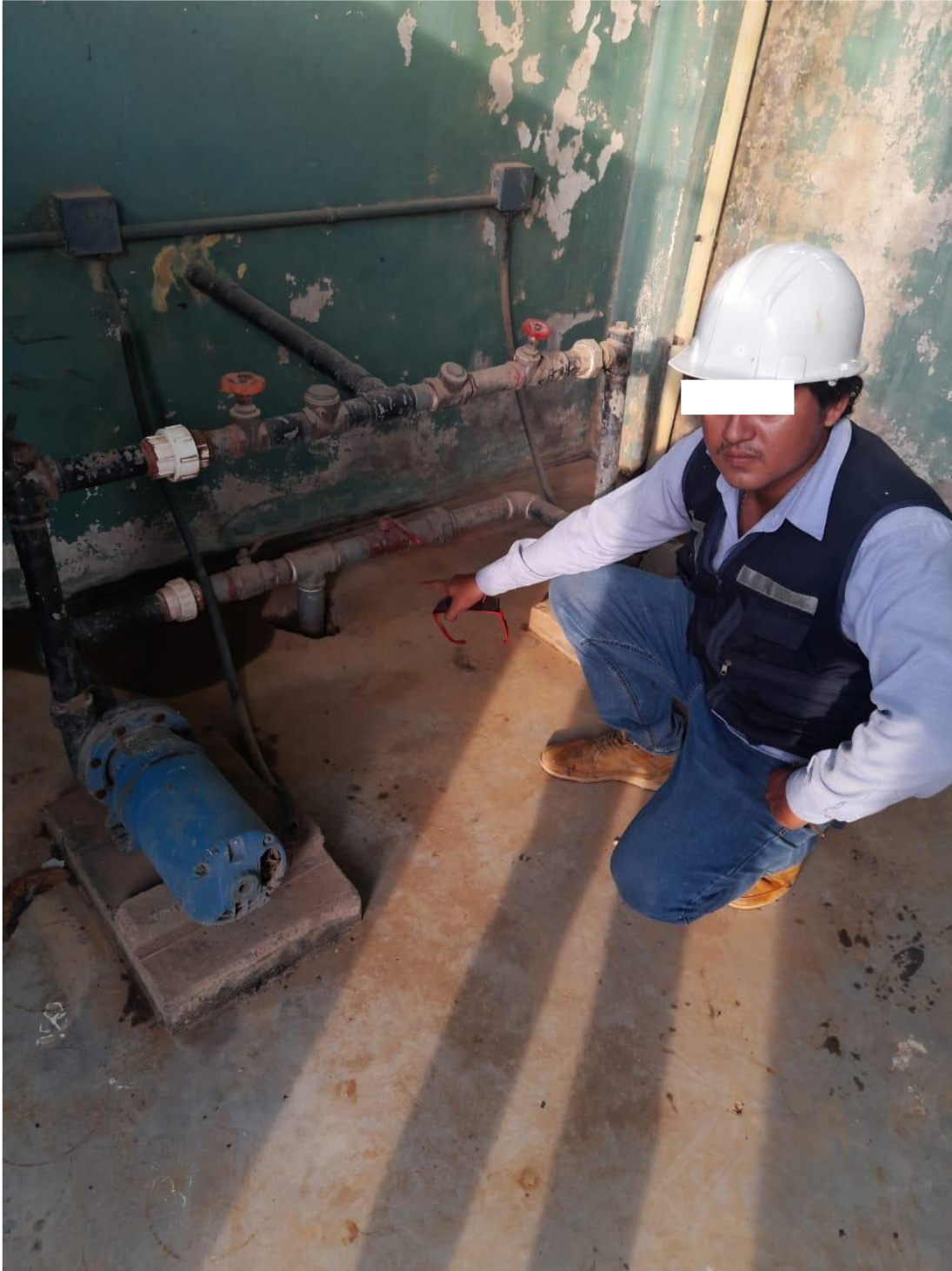
Imagen 17: Sala de maquina
