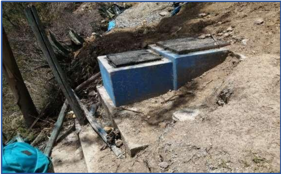
Fotografía N° 3. Vista de la cámara rompe presión
