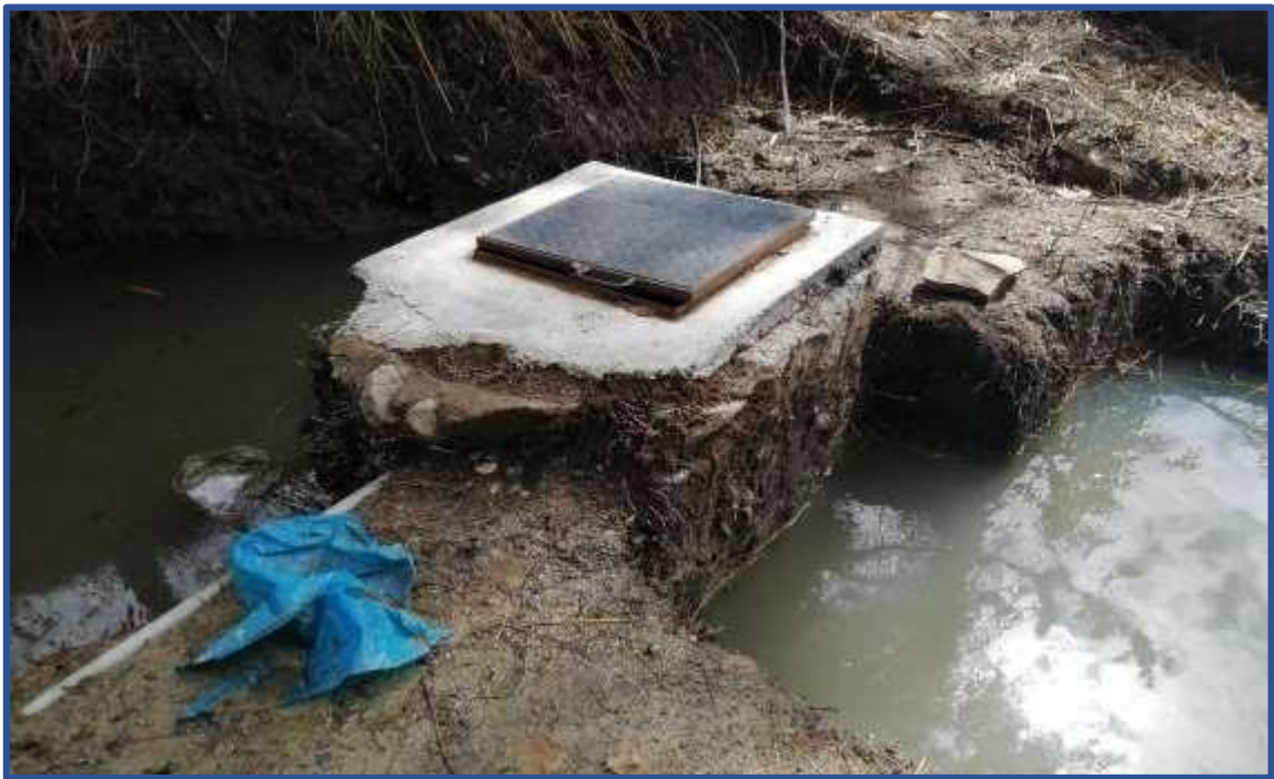
Fotografía N° 1. Vista de la captación inoperativa, por antigüedad de construcción.
