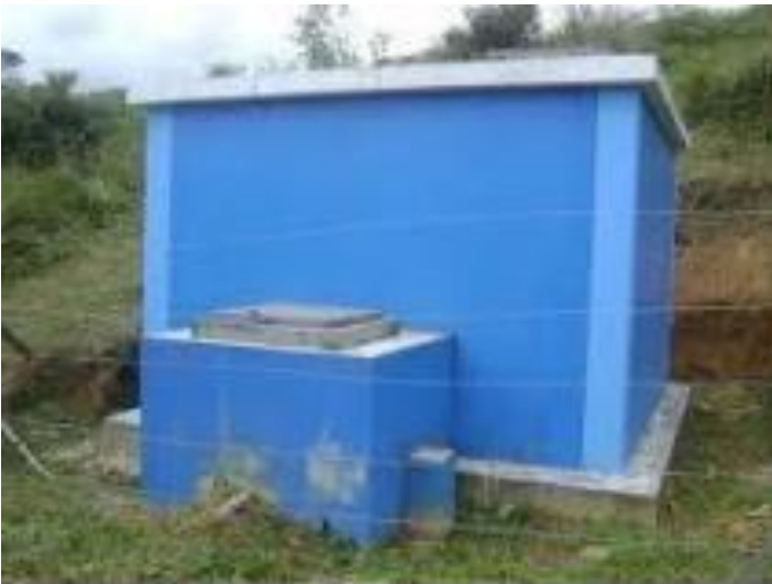
Imagen 4: Reservorio del caserío Villa Las Mercedes, distrito de Moro, Provincia de Santa, departamento de Ancash- 2022.
