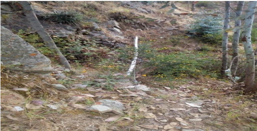
Imagen 3. Situación en la que se encuentra un tramo de las tuberías de aducción del caserío Villa Las Mercedes.
