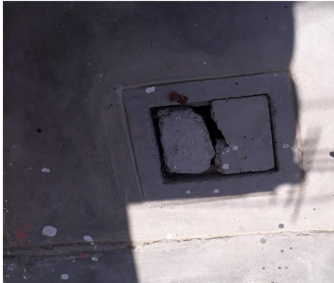
Ilustración 9 Vista exterior de las conexiones domiciliarias
