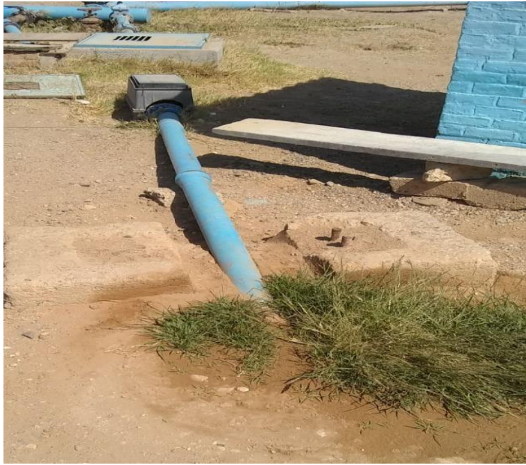
Ilustración 8 Vista exterior de línea de aducción.
