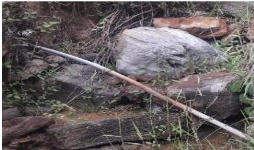
Imagen 5 Línea de aducción expuesta
