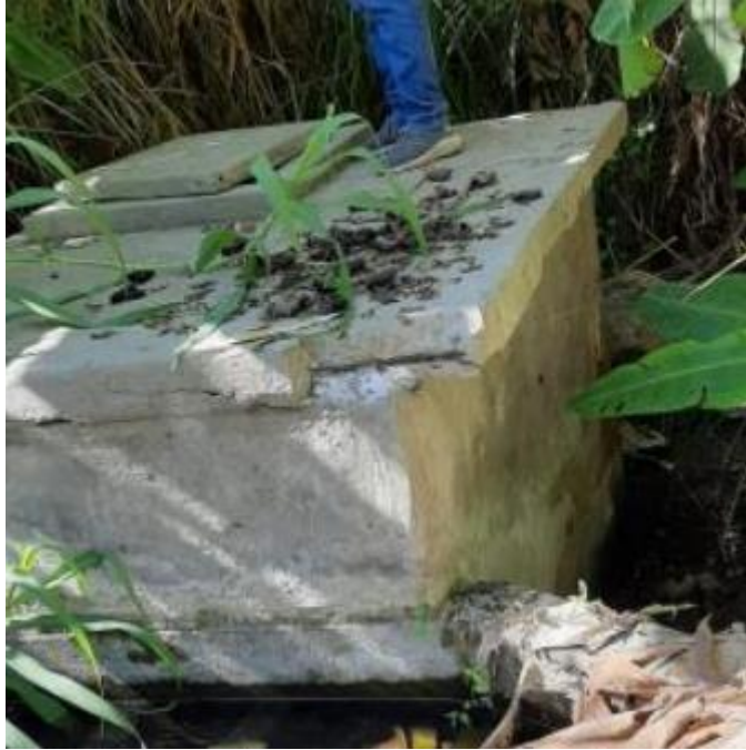
Imágen 4 Obra de captación por manantial de ladera deteriorada
