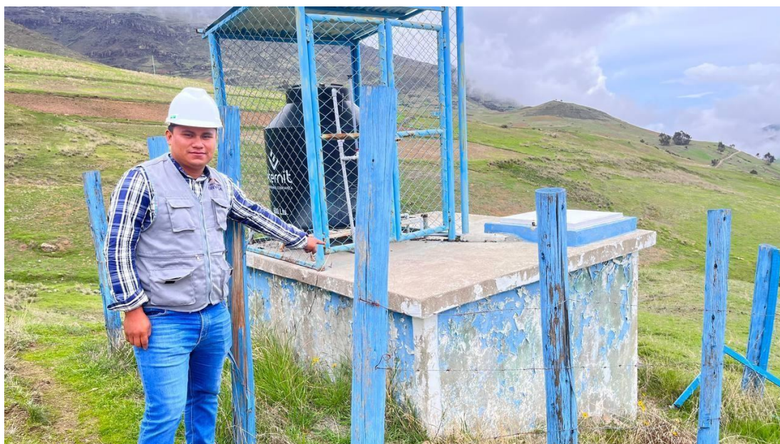
Imagen 4 Reservorio sin cerco perimétrico adecuado y desprendimiento de la pintura
