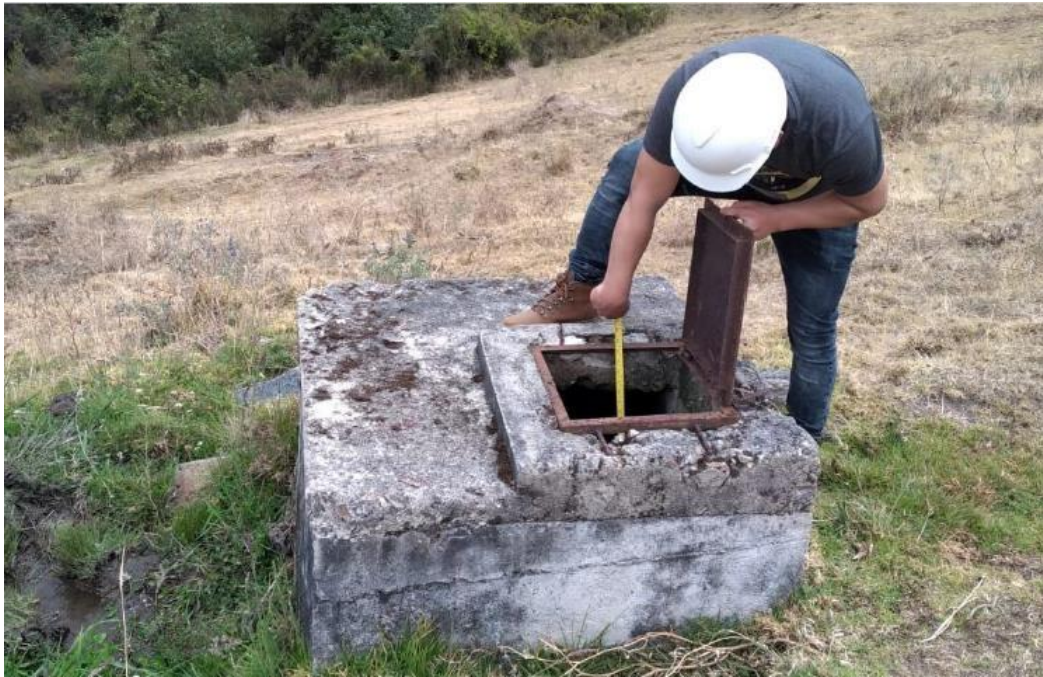
Imagen 2 Cámara rompe presión tipo 6 deteriorada
