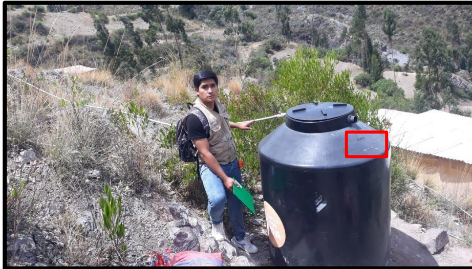
Imagen N° 03: Se logra observar que el tanque de almacenamiento no cuenta con cerco perimétrico y presenta roturas alrededor de la parte superior.
