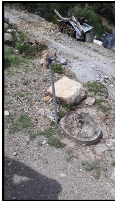
Imagen N°6: Se observa el grifo domiciliario, de esa manera se abastecen los pobladores diariamente.
