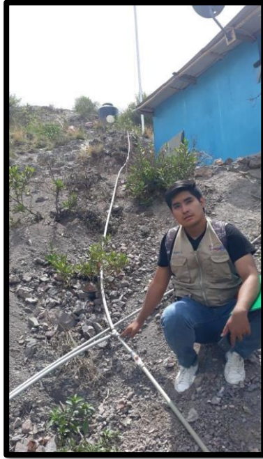
Imagen N° 05: Se puede apreciar que la red de distribución se encuentra al aire libre, sus llaves de paso se encuentran deterioradas y las tuberías presentan empalmes.
