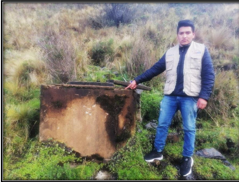
Fotografía 07: Se observa el mal estado de la cámara rompe Presión.
