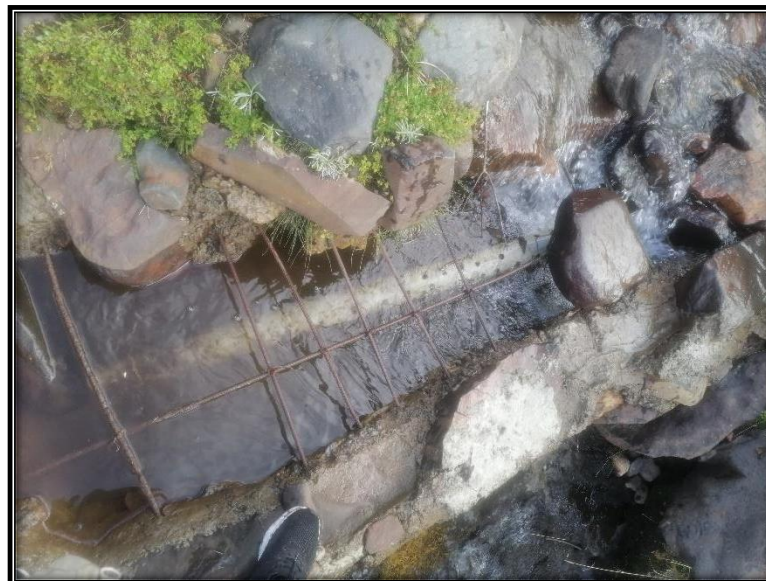
Fotografía 02: Estado actual de la captación, donde se observa su mal estado en el que se encuentra.
