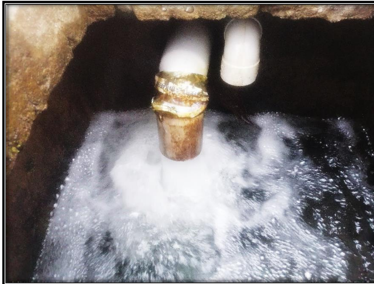
Fotografía 06: Estado actual de las cámaras rompe presión.
