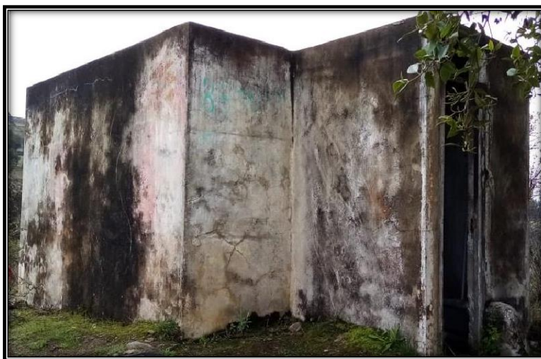
Fotografía 09: Estado actual del reservorio, donde se observa su mal estado.
