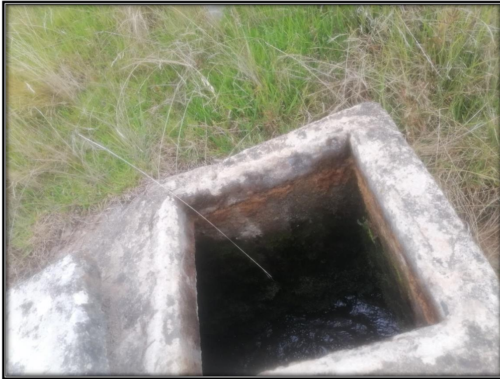
Fotografía 13: Verificación del estado actual de las cajas de repartición, donde se observa que la estructura presenta corrosión y no tiene mantenimiento
