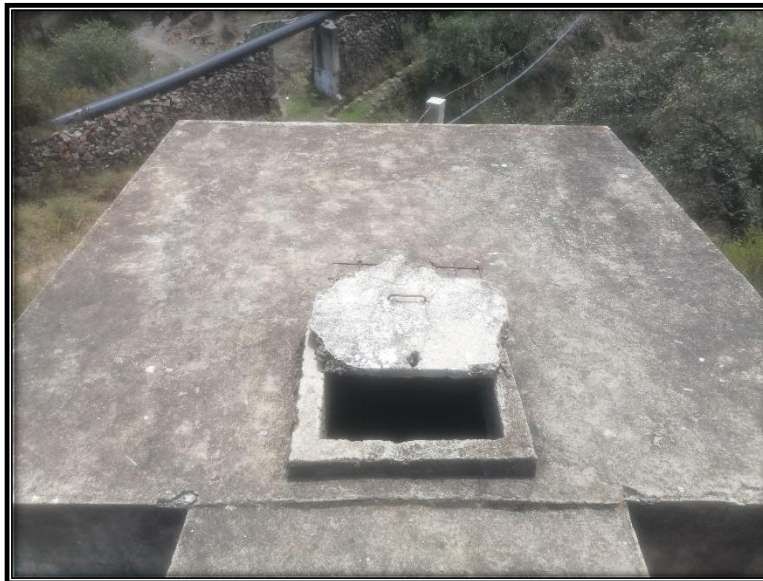
Fotografía 08: Se observa la tapa dañada y desgastada del reservorio.
