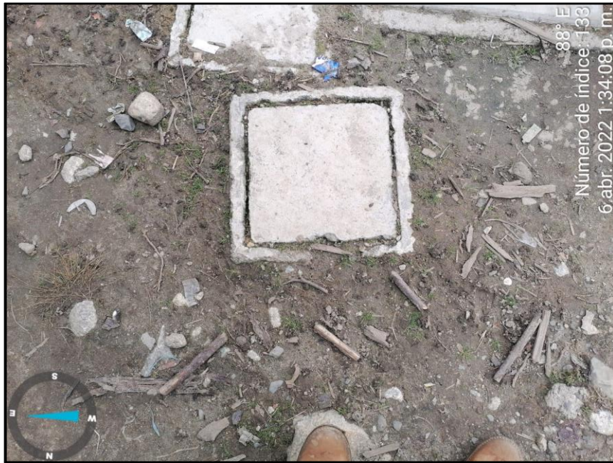
Figura 29: Caja de registro de conexiones domiciliarias
