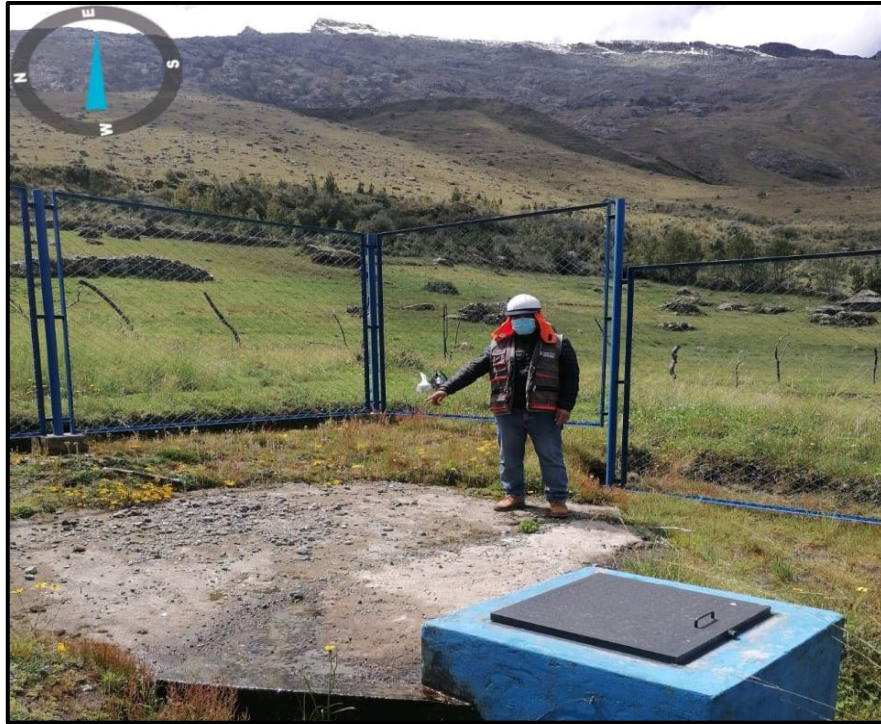
Figura 21: Cámara de captación del caserío Pumahuasi
