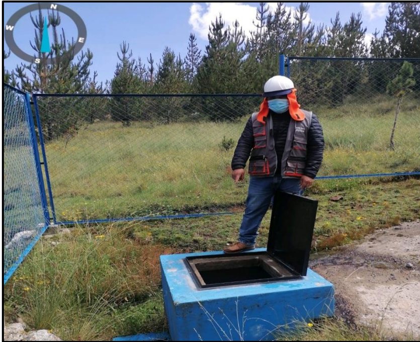
Figura 23: Tapa metálica cámara húmeda
