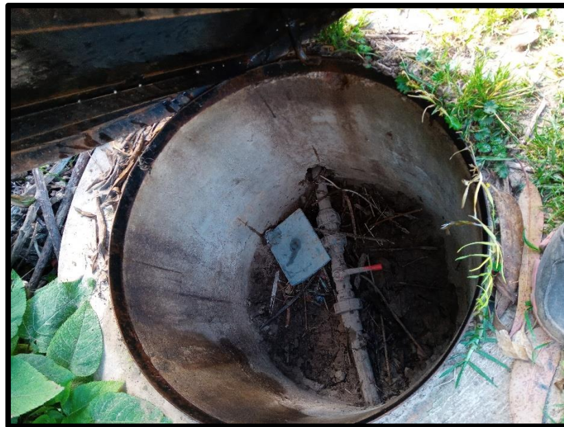
Figura 36: válvula de purga caserío santa rosa de Huashla Fuente: Toma fotográfica propia 2023
