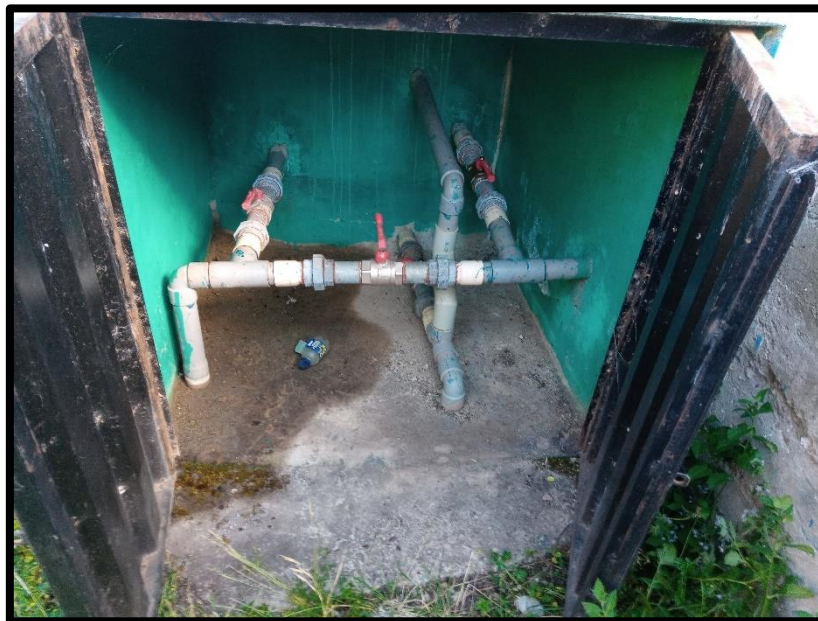
Figura 30: Caseta de válvulas del reservorio de caserío santa osa de Huashla Fuente: Toma fotográfica propia 2023
