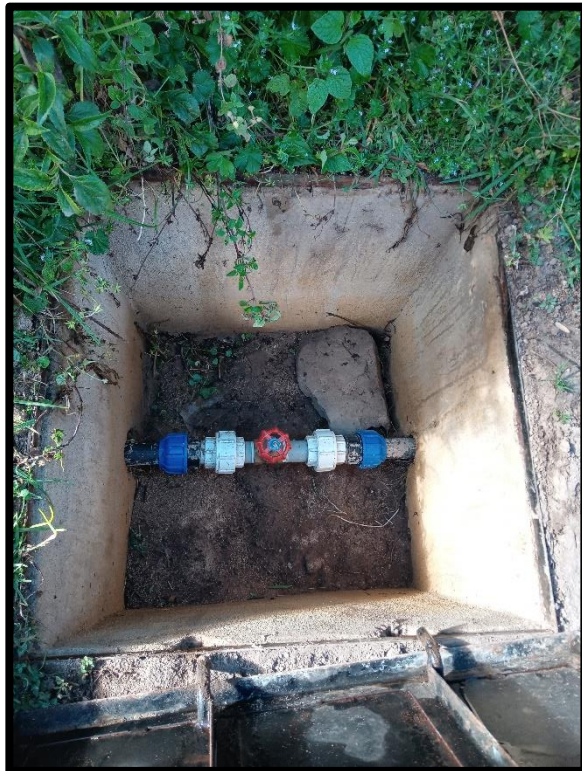
Figura 34: Caja de válvula caserío santa rosa de Huashla Fuente: Toma fotográfica propia 2023
