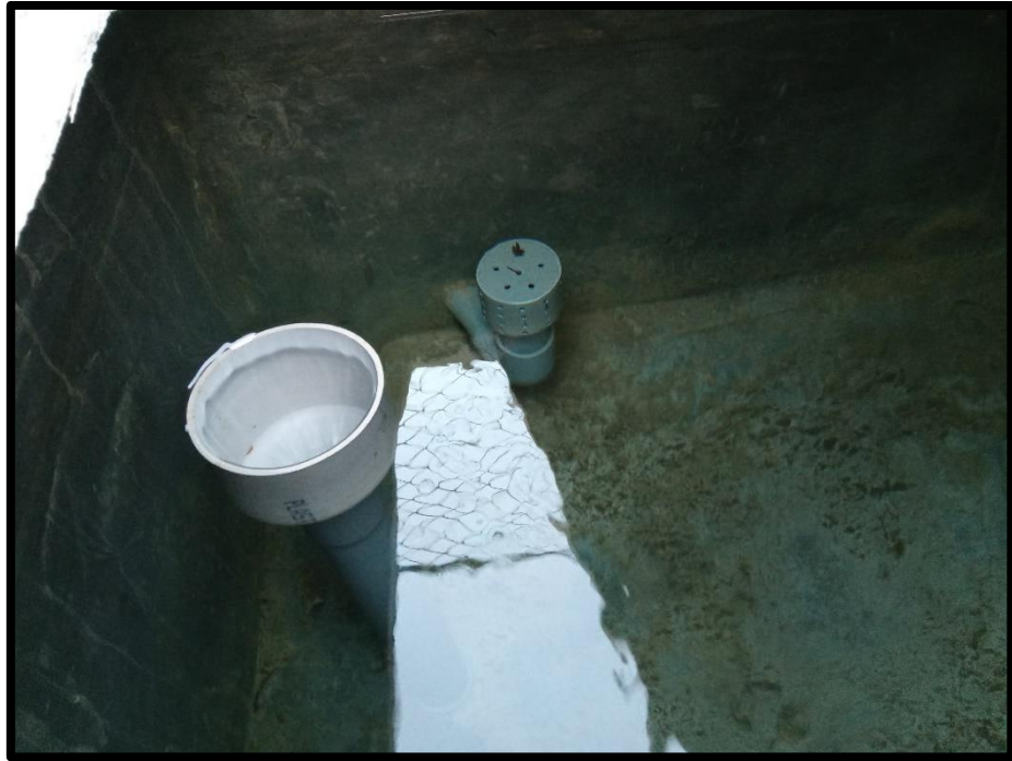
Figura 27: Interior cámara húmeda caserío santa rosa de Huashla Fuente: Toma fotográfica propia 2023
