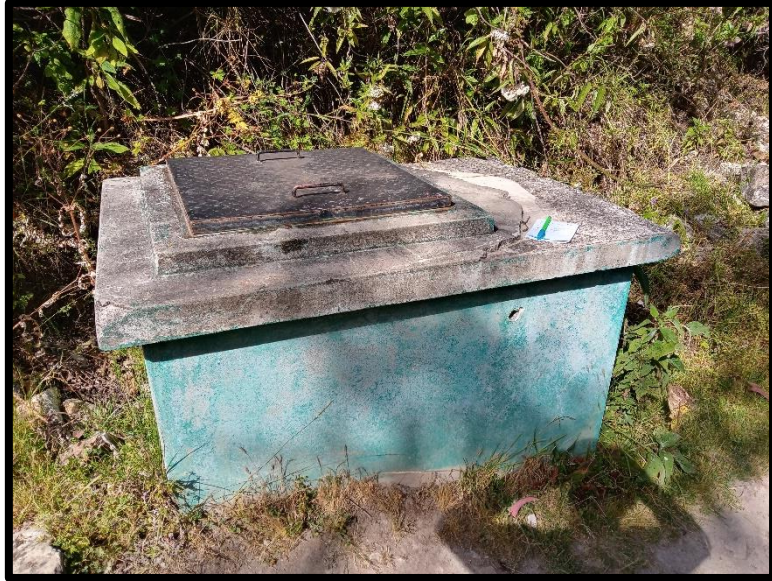
Figura 33: CRP-T caserío santa Rosa de Huashla Fuente: Toma fotográfica propia 2023
