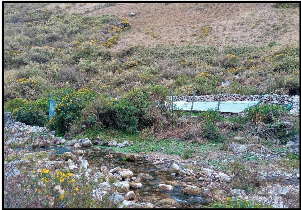
Figura 23: Estructura de captación del sistema al lado del río del caserío santa Rosa de Huashla
