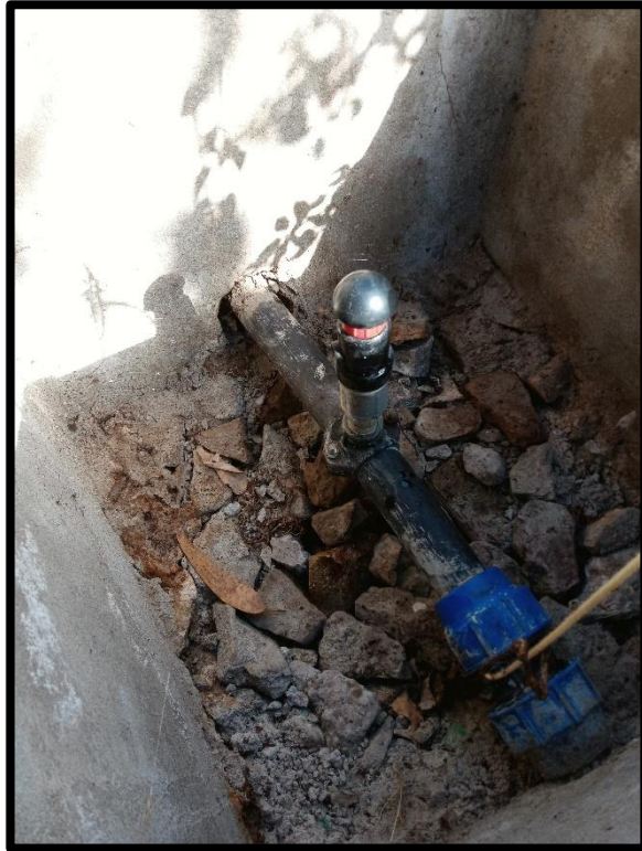
Figura 35: Válvula de aire caserío santa rosa de Huashla Fuente: Toma fotográfica propia 2023
