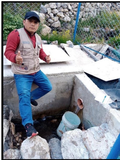
Figura 22: Evaluando la captación del sistema de agua potable, información de campo Fuente: Toma fotográfica propia 2023
