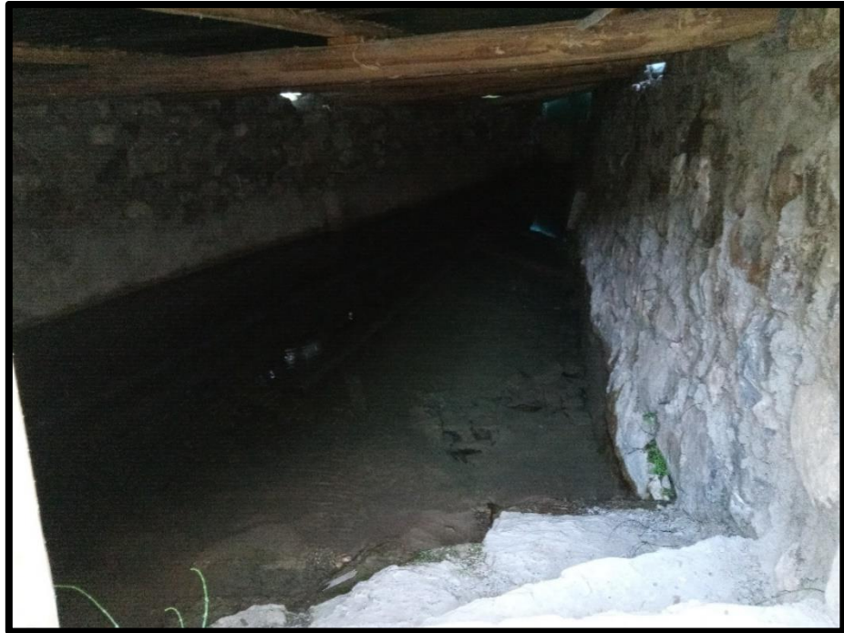
Figura 25: Interior de cámara recolectora de caudal caserío santa rosa de Huashla Fuente: Toma fotográfica propia 2023
