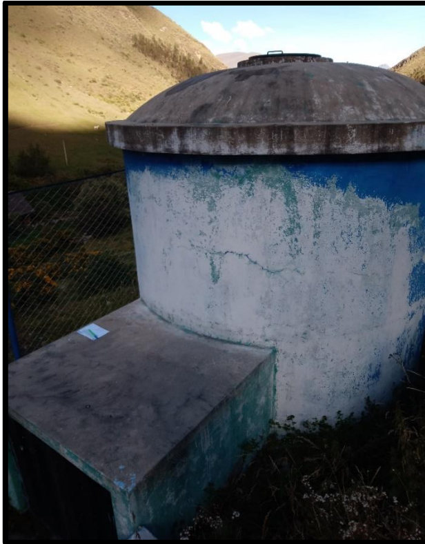
Figura 29: Fisura longitudinal en el reservorio caserío santa rosa de Huashla Fuente: Toma fotográfica propia 2023
