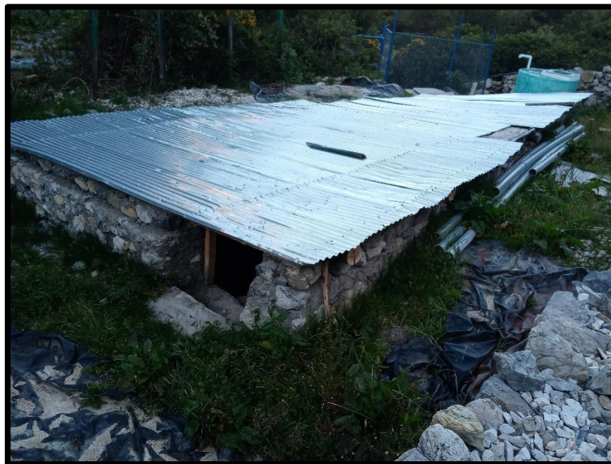
Figura 24: Exterior de cámara recolectora de caudal caserío santa rosa de Huashla
