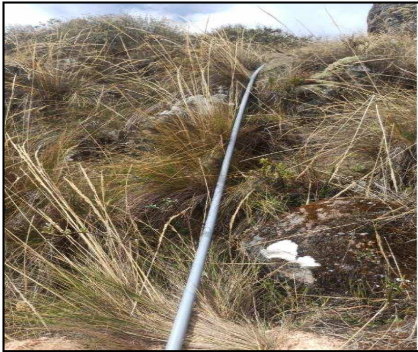
Figura 7: Tubería en la línea de conducción expuesta.
