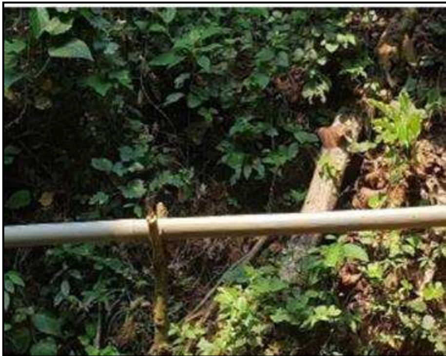
Figura 2: Tubería en la línea de conducción expuesta
