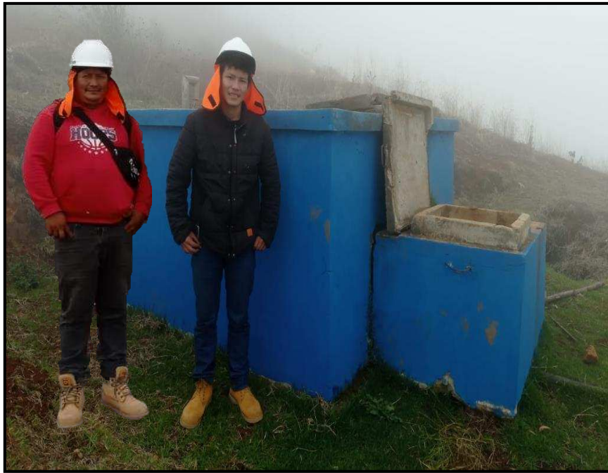
Figura 9: Reservorio con caseta de válvulas dañadas
