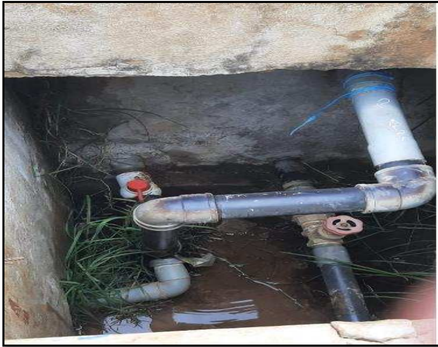
Figura 3: Válvulas presenta filtraciones
