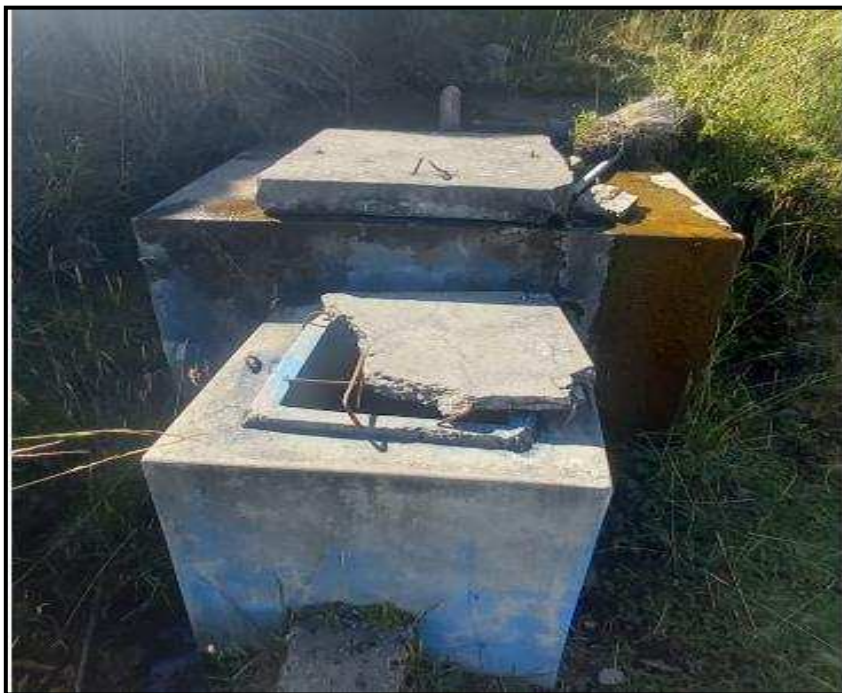
Figura 8: Estructura de captación en estado Malo
