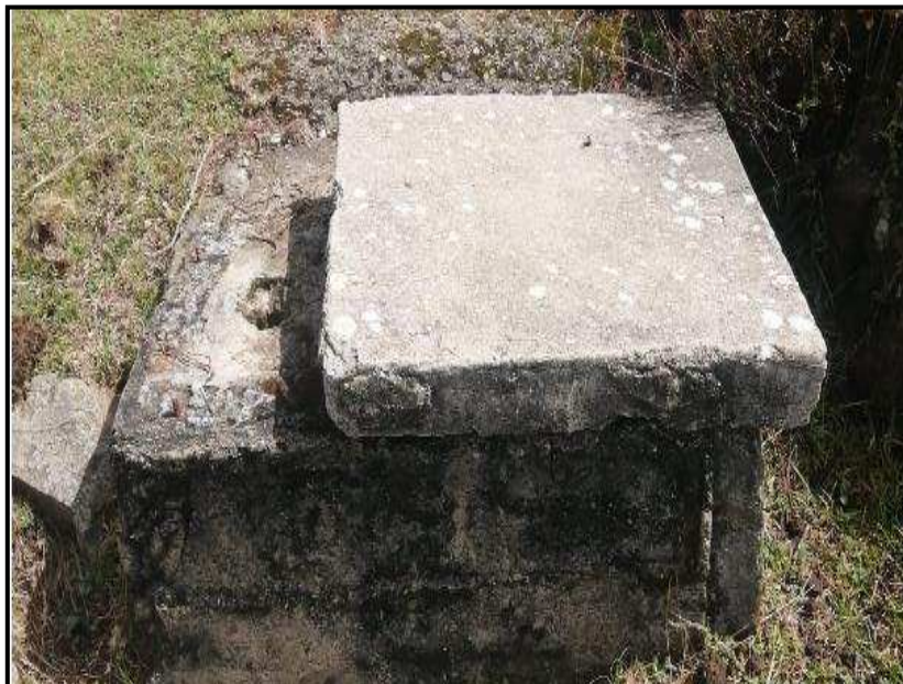
Figura 6: Única cámara rompe presión en el sistema.
