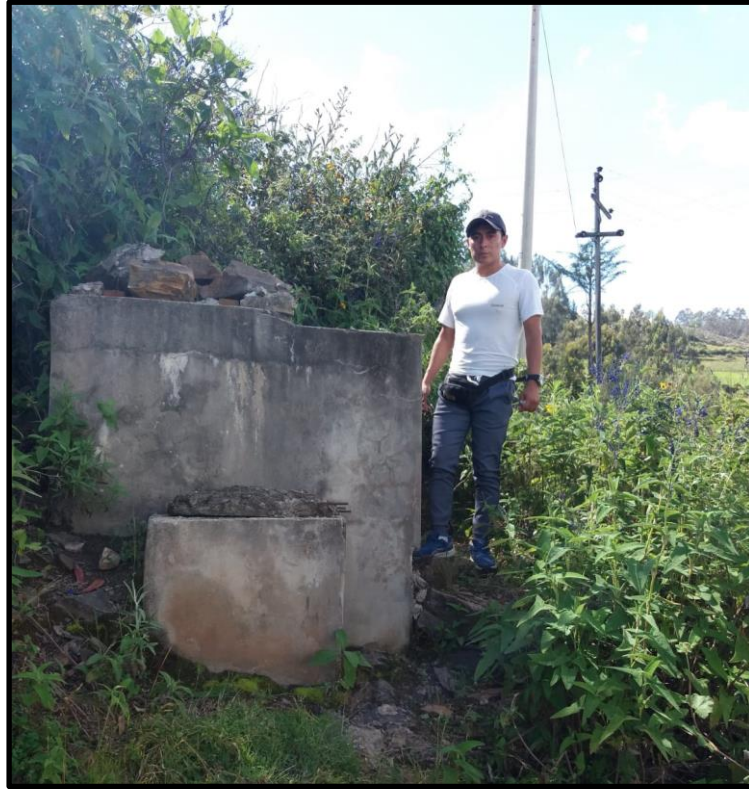
Figura 40: Captación tipo ladera
