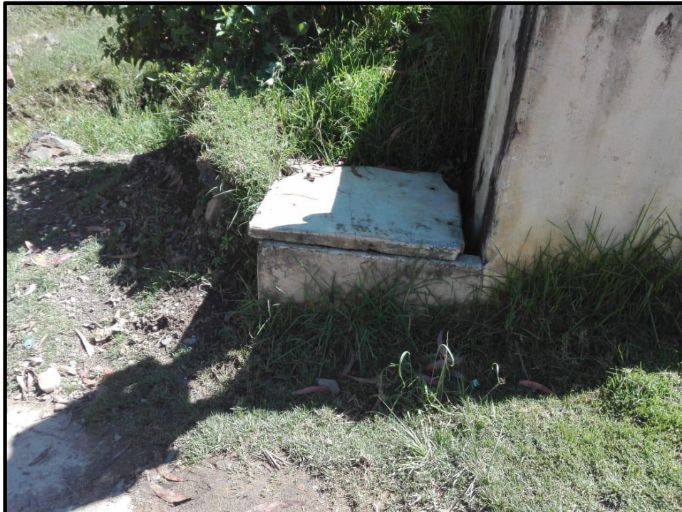
Figura 43: Reservorio (caja de válvulas)
