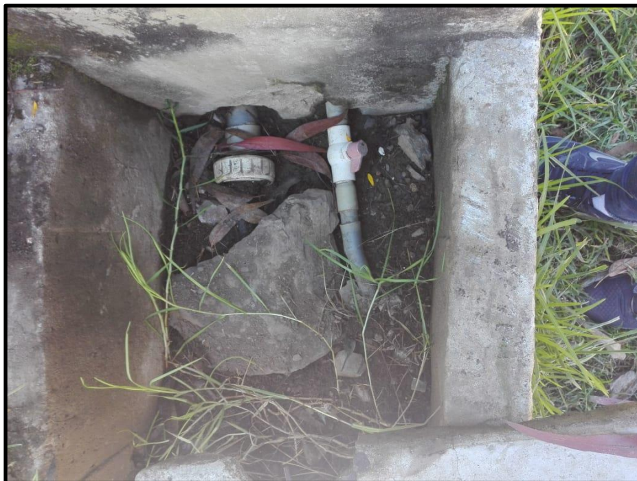
Figura 44: Reservorio (caja de válvulas)
