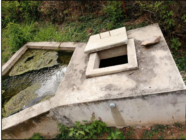
Figura 15: Captación del sistema de abastecimiento de agua potable del caserío de Colcap.
