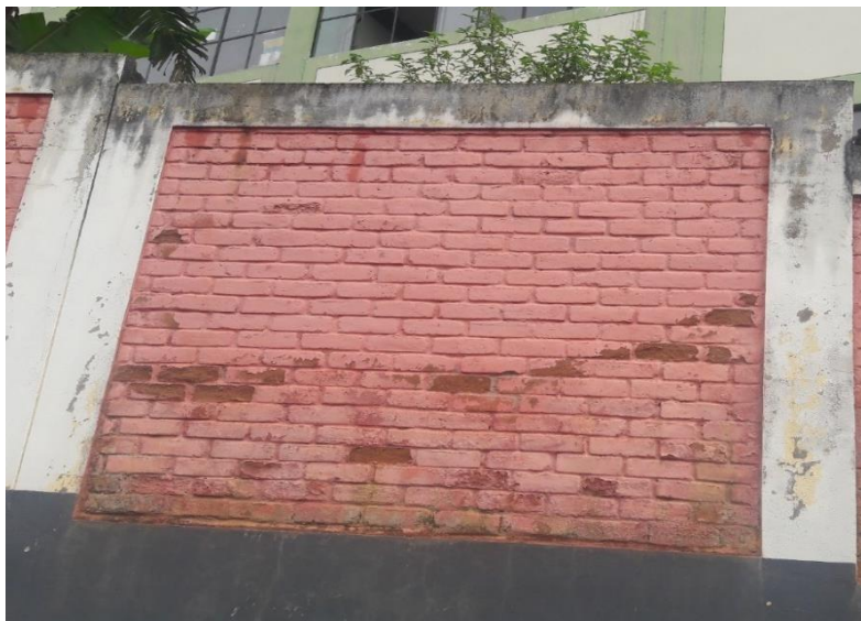
Gráfico 1: presencia de erosión en muro
