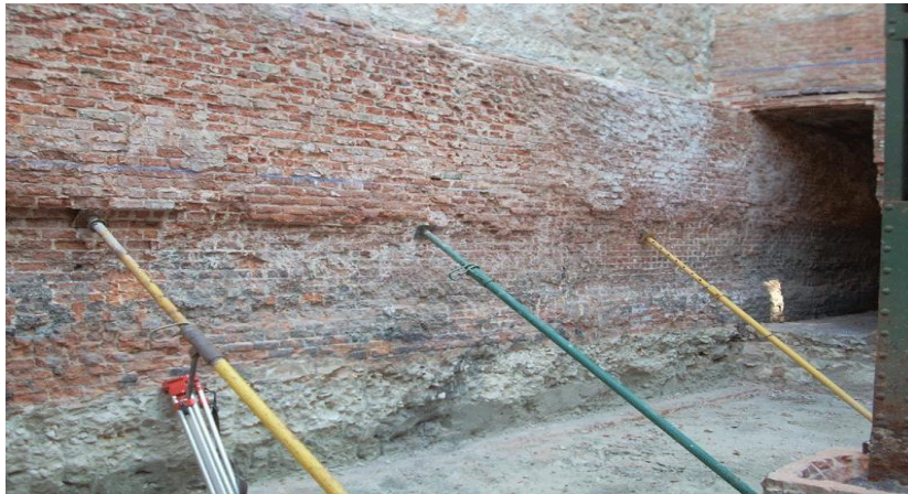
Gráfico 4: presencia de deformación en muros
