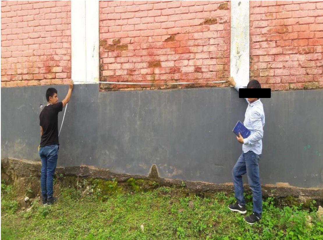
Se observa Presencia de erosión
