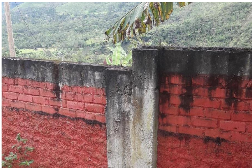
Gráfico 3: presencia de suciedad en muros
