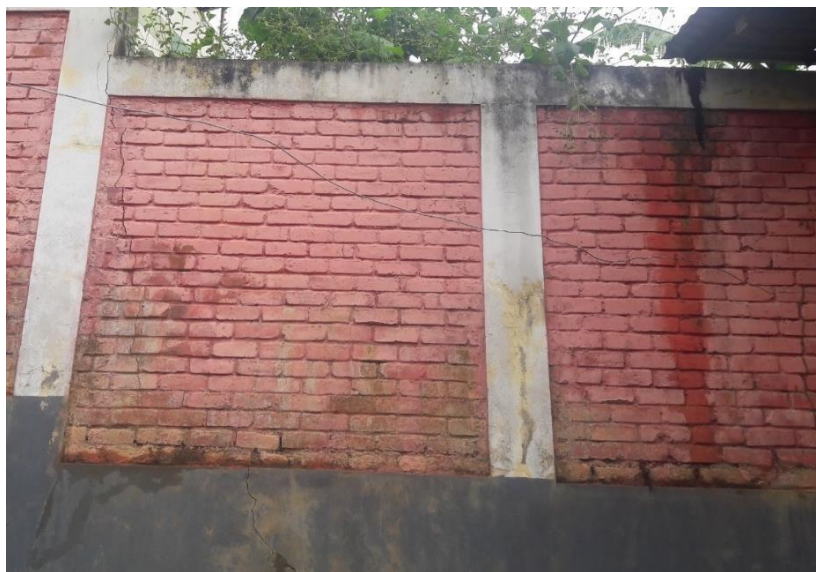
Gráfico 5: presencia de grietas en muros
