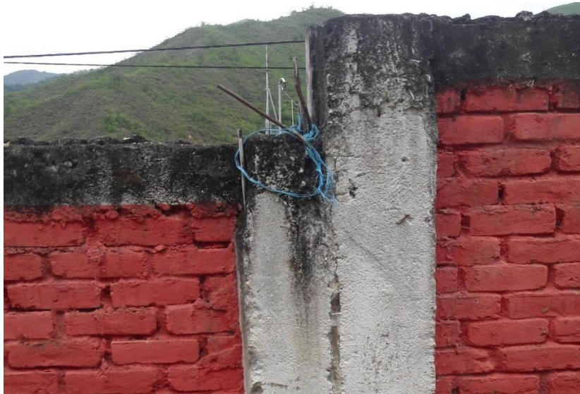
Gráfico 8: presencia de oxidación del acero
