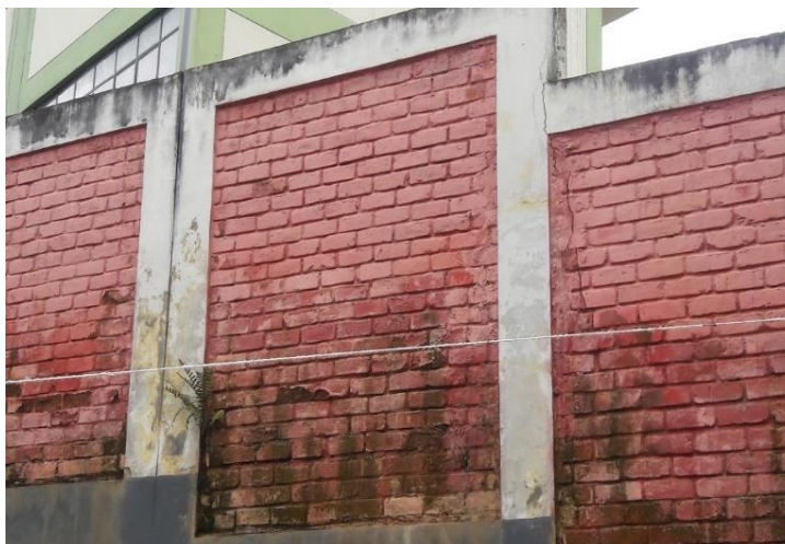
Gráfico 2: presencia de humedad en columnas _ muros
