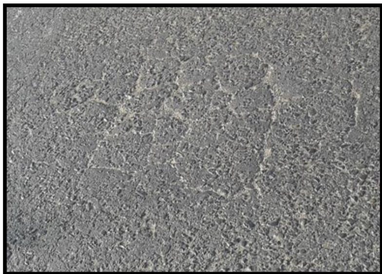
Figura_18 Grieta en Bloque
