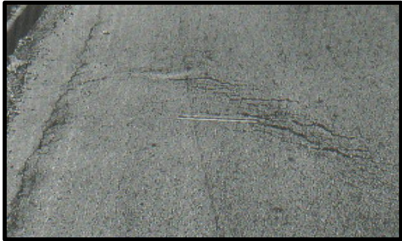
Figura_32 Fisura Parabólica
