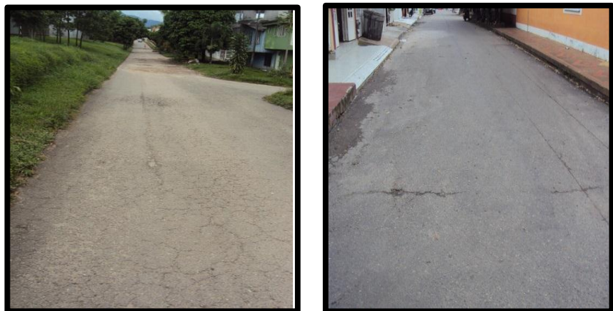
Figura_1 Fisuras De Los Pavimentos Flexibles.
