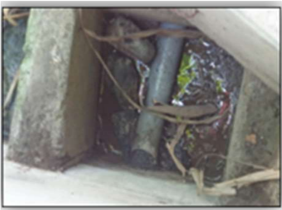
Imagen n° 04, Tuberias de salida, se encuentra expuesta y deteriorada.
