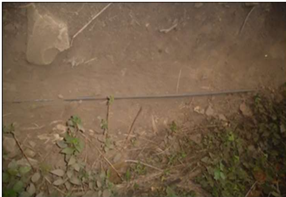
Imagen n° 06, Tuberías de distribucion expuestas, decoloradas y deformadas
