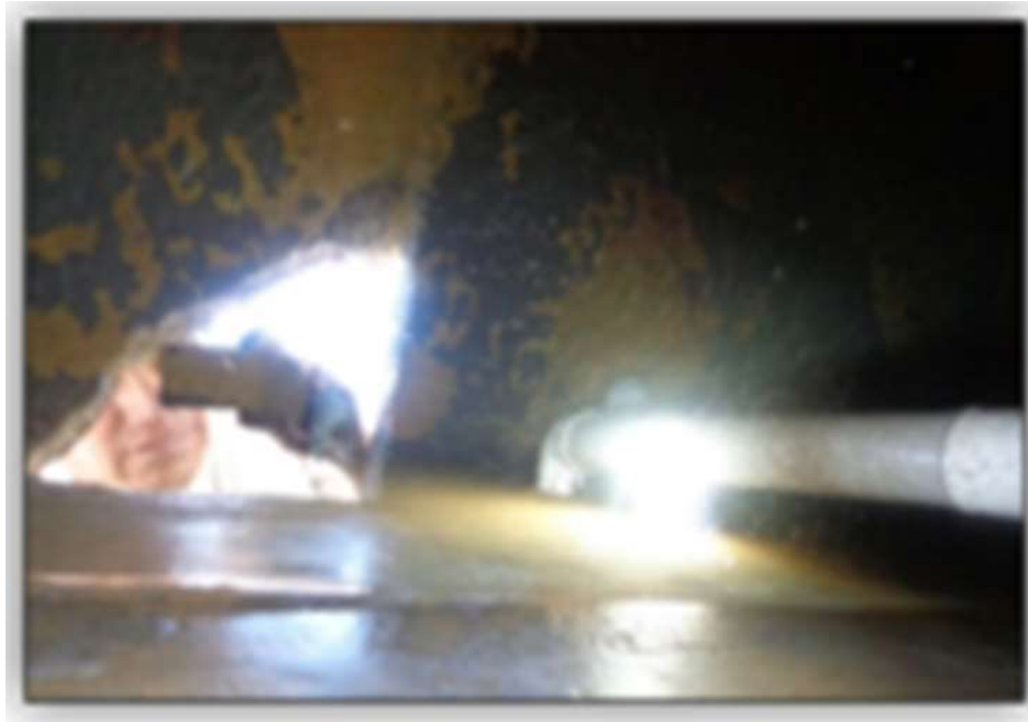
Imagen n° 05, Tuberías de ventilacion en mal estado, doblado y decolorado
