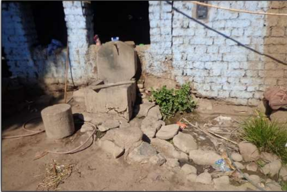
Imagen n° 03, Coneccion domiciliaria en malas condiciones
