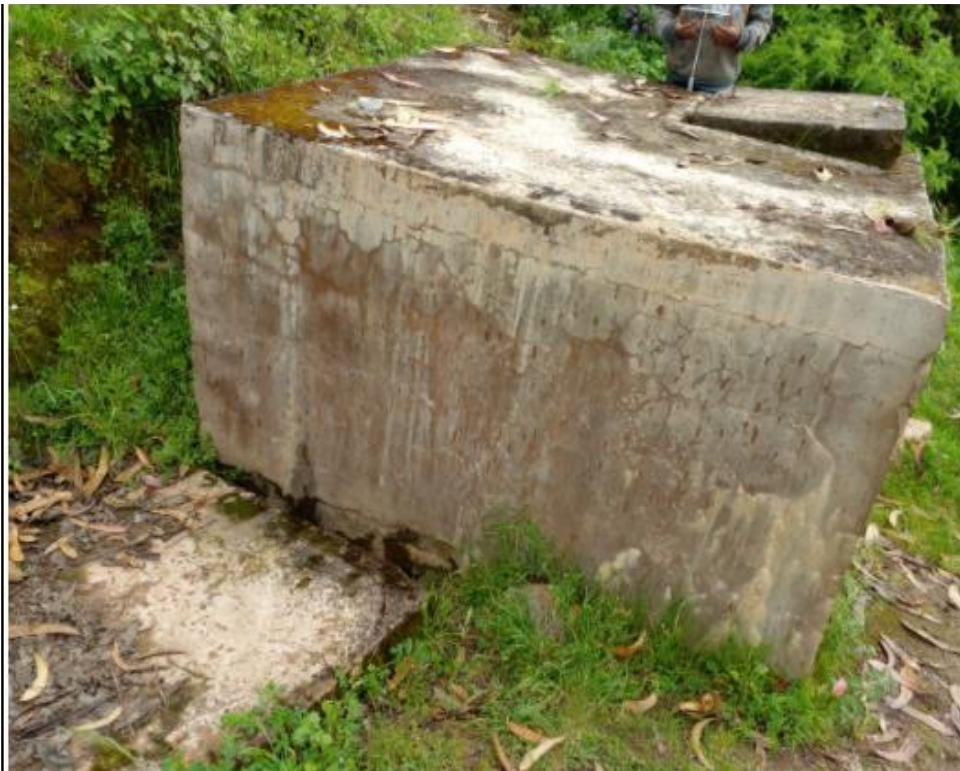
Figura 06: 1er Reservorio del Caserío Parac
