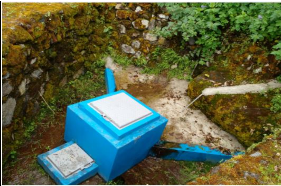
Figura 02: Cámara de Captación del Caserío de Parac
