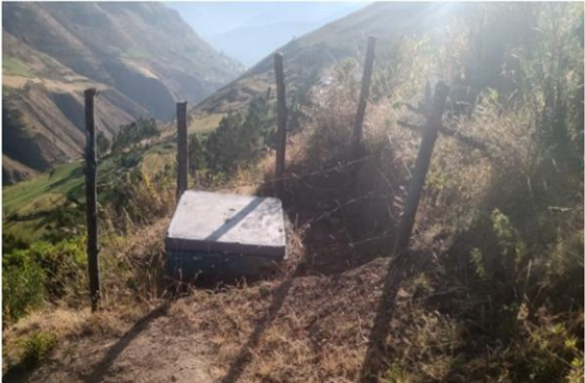
Figura 09: Cámara rompe presión tp 7
