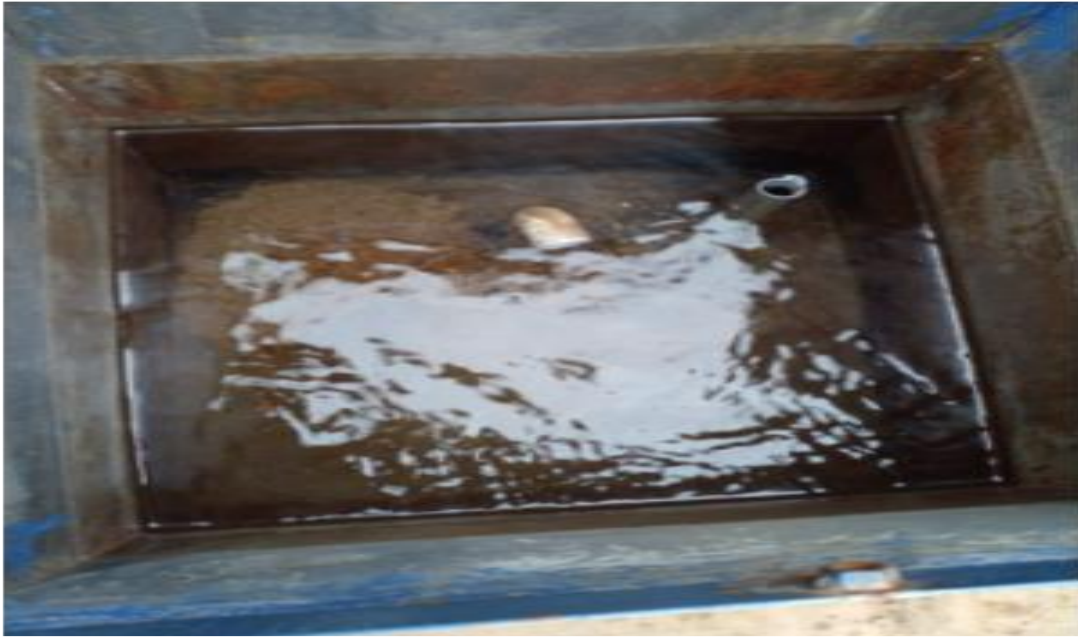
Figura 05: Interior de la Cámara Rompe Presión
