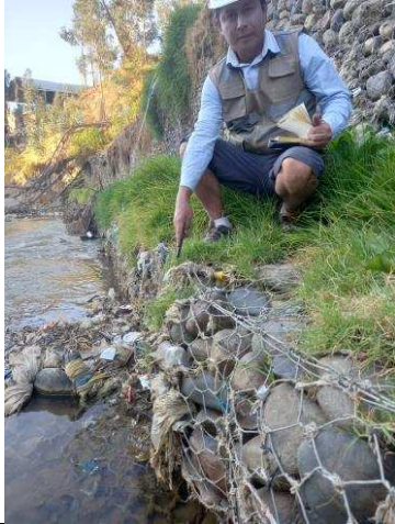
Foto N° 55: Volcamiento de rocas en la puntera del muro (1.0x0.4), prog. 0+084.
