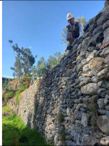
Foto N° 50: Inclinación del fuste de muro del tramo 8, prog. 0+075.
