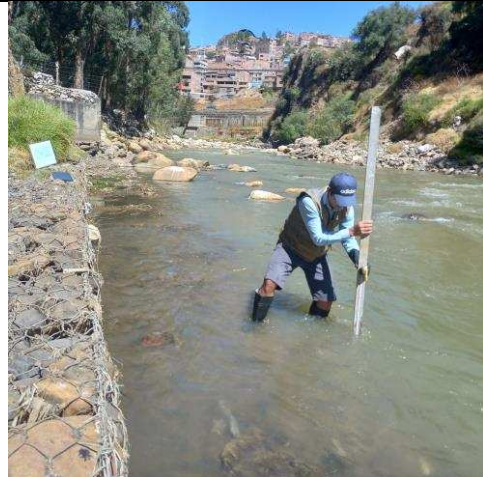
Foto N° 08: Medición de la deflexión del colchón reno y socavación en el tramo 4.
