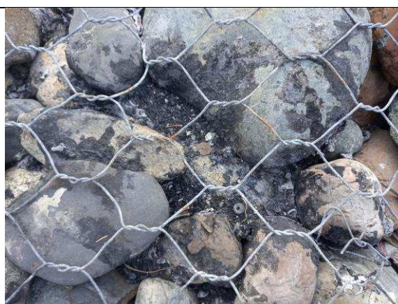
Foto N° 70: Proceso de corrosión en los alambres del gavión, prog. 0+018.
