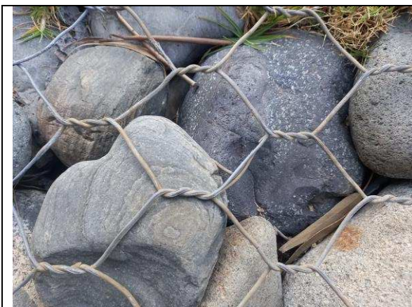
Foto N° 67: Deterioro de cobertura (PVC) del alambre galvanizada, prog. 0+000-0+003.
