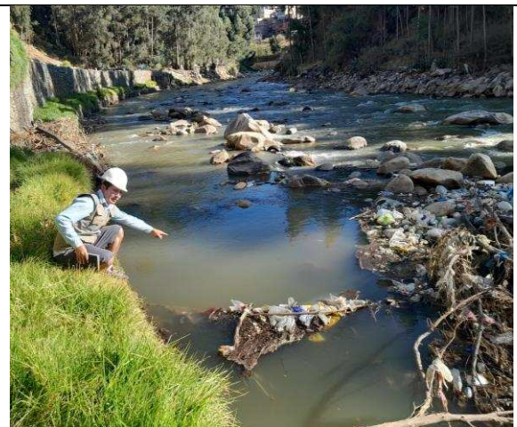
Foto N° 28: Acumulación de basura sobre el colchón antisocavante, prog. 0+110
