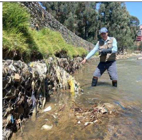
Foto N° 12: Acumulación de basura sobre el colchón antisocavante, prog. 0+053.
