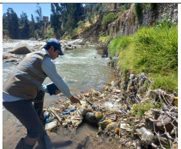
Foto N° 24: Rotura de malla del colchón antisocavante, prog. 0+084.
