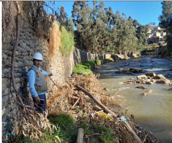
Foto N° 57: Acumulación de ramas y palos de eucalipto, prog. 0+090-0+100.
