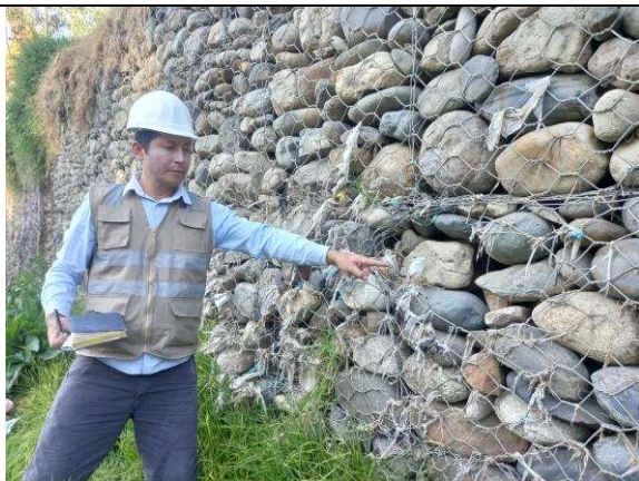
Foto N° 53: Rotura de malla del gavión (0.68x0.40) a una altura de 2.6m del fuste de muro, prog. 0+083.
