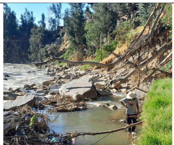
Foto N° 30: Acumulación de basura sobre el colchón antisocavante, prog. 0+120
