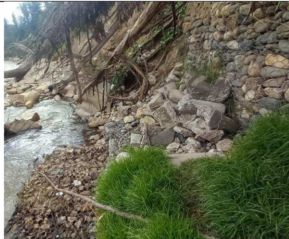
Foto N° 64: Escombros sobre la puntera del muro, prog. 0+122-0+125.
