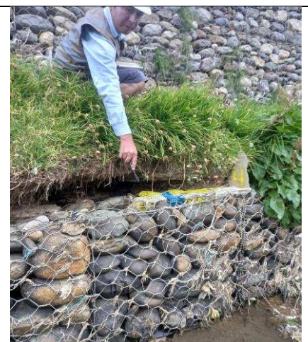
Foto N° 41: Desplazamiento de rocas en la puntera del muro (0.45x0.2), prog. 0+041.
