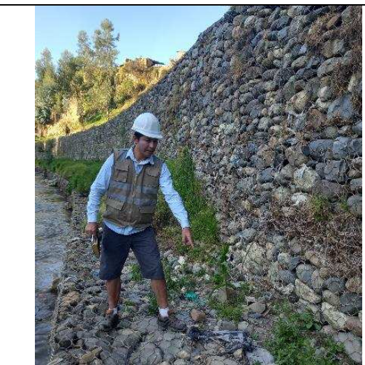
Foto N° 36: Tramo 3 sin vegetación sobre la puntera del muro, prog. 0+021-0+029.
