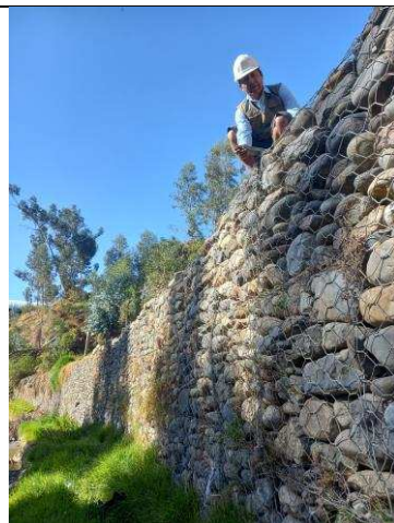
Foto N° 48: Inclinación del fuste de muro del tramo 7, prog. 0+065.
