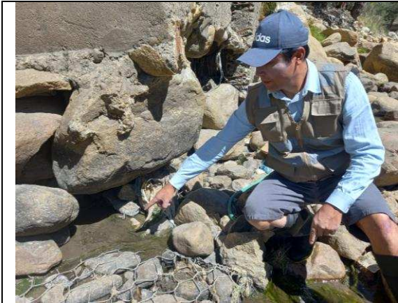
Foto N° 31: Filtración por debajo del muro de gaviones, prog. 0+000
