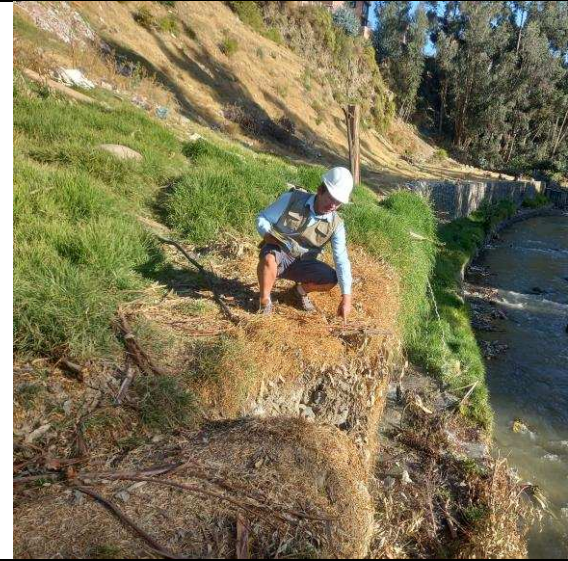
Foto N° 73: Hundimiento de la corona a causa de caída de árbol, prog. 0+099.
