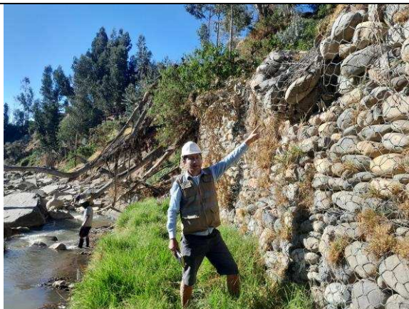
Foto N° 65: Volcamiento de la última fila de gaviones, prog. 0+113.
