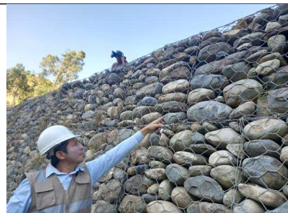
Foto N° 77: Relleno de rocas inadecuadas, diámetros de rocas desde 10cm hasta 44cm.
