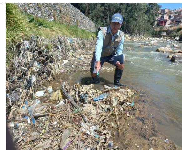
Foto N° 23: Acumulación de basura sobre el colchón antisocavante, prog. 0+085.
