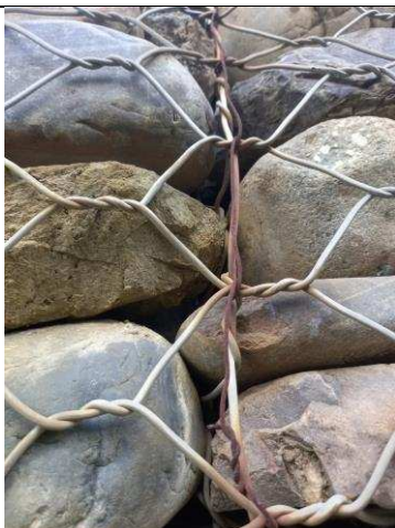
Foto N° 47: Corrosión del alambre de amarre, última fila de gaviones, prog. 0+055 - 0+125.
