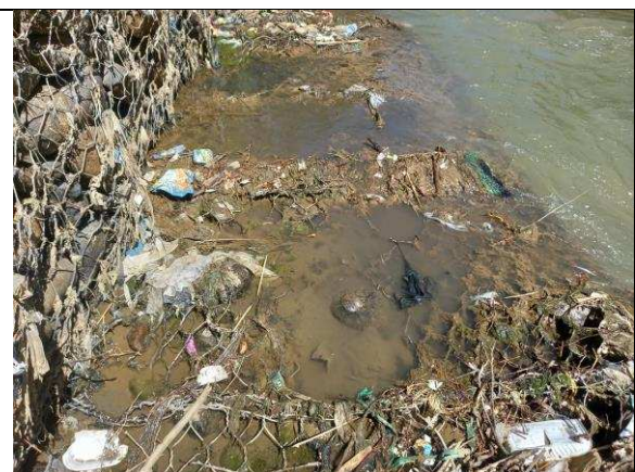
Foto N° 18: Detalle de la rotura (0.60x0.43 y 0.50x0.40) del colchón, prog. 0+074.
