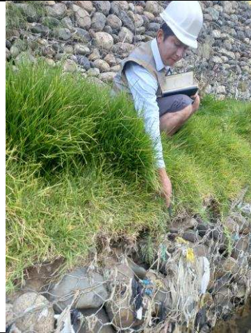
Foto N° 44: Rotura de malla en la puntera del muro (0.34x0.25), prog. 0+054.
