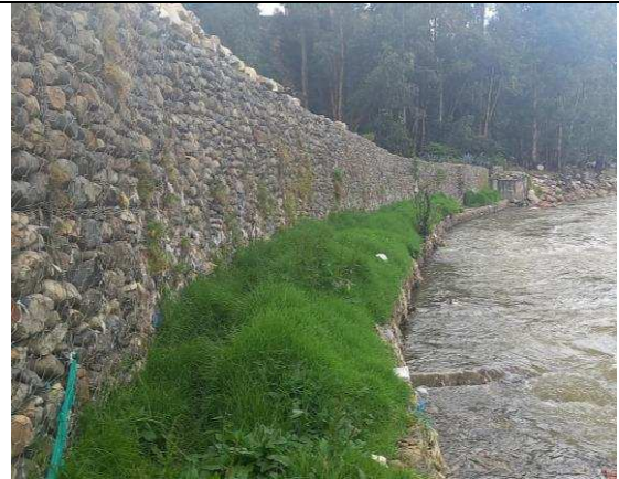
Foto N° 32: Vegetación sobre la puntera, prog. 0+000-0+021, 0+029-0+090 y 0+100-0+122.
