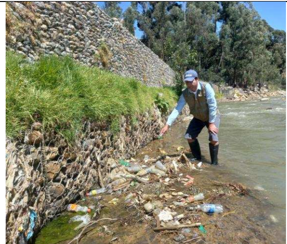
Foto N° 16: Acumulación de basura sobre el colchón antisocavante, prog. 0+070.
