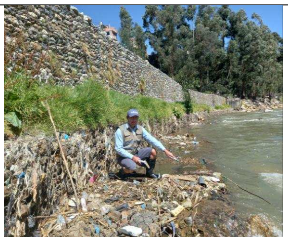
Foto N° 22: Acumulación de basura sobre el colchón antisocavante, prog. 0+084.
