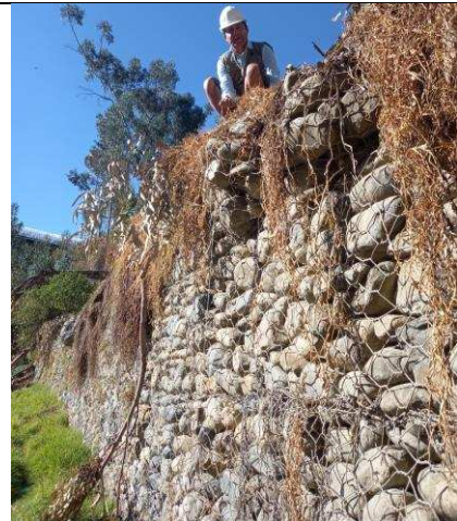
Foto N° 58: Inclínación de muro del tramo 10. Volcamiento de gaviones, prog. 0+099.
