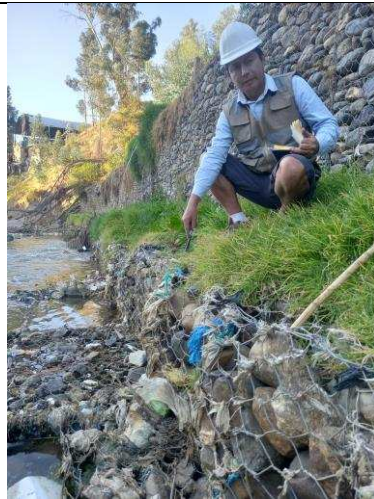
Foto N° 52: Volcamiento de rocas en la puntera del muro (1.0x0.4), prog. 0+080.
