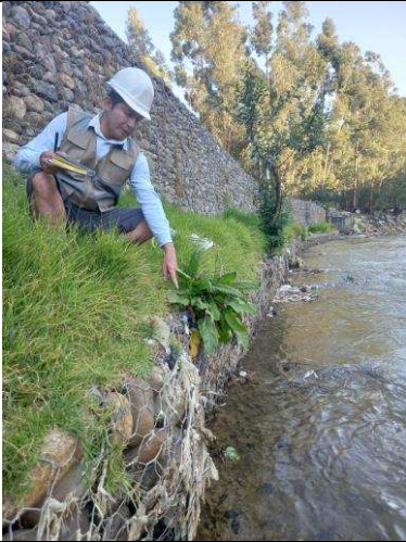
Foto N° 49: Volcamiento de rocas en la puntera del muro (1.0x0.4), prog. 0+066.
