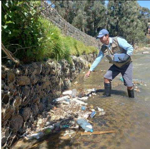
Foto N° 13: Acumulación de basura sobre el colchón antisocavante, prog. 0+060.
