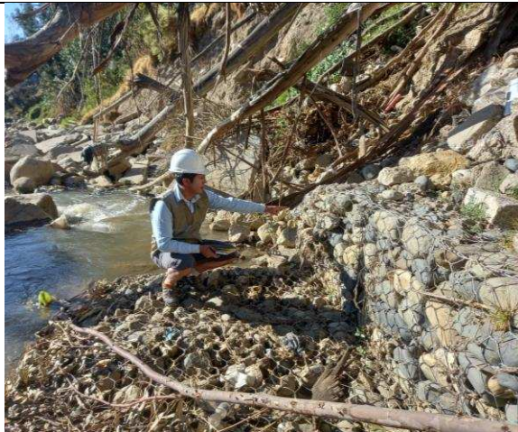
Foto N° 63: Volcamiento de rocas en la puntera del muro (1.0x0.4), prog. 0+125.
