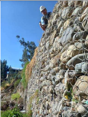
Foto N° 51: Inclinación del fuste de muro del tramo 9, prog. 0+085.
