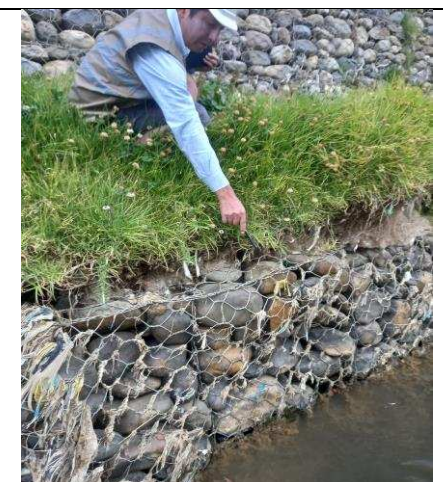
Foto N° 42: Desplazamiento de rocas en la puntera del muro (1.35x0.4), prog. 0+044.
