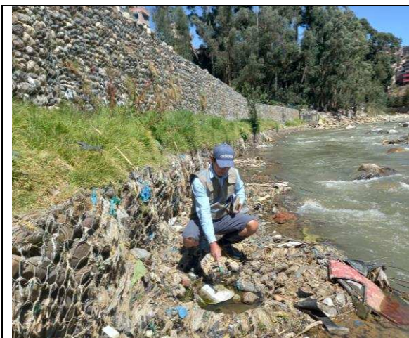
Foto N° 19: Rotura de malla del colchón antisocavante, prog. 0+080.
