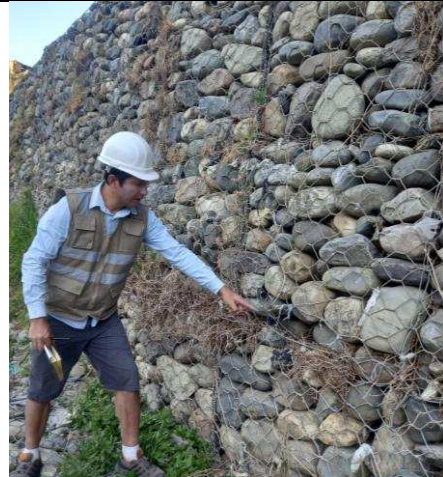
Foto N° 38: Rotura de malla del gavión (0.48x0.20) a una altura de 2.0m, prog. 0+024
