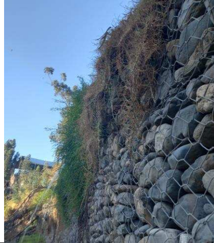
Foto N° 56: Volcamiento de la última fila de gaviones, prog. 0+088.
