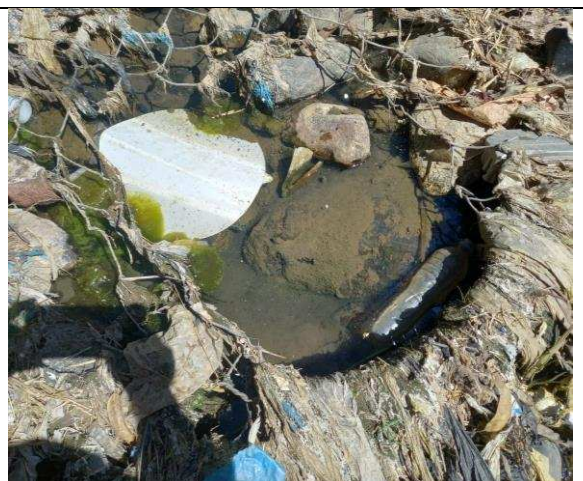
Foto N° 20: Detalle de la rotura (0.70x0.50) del colchón, prog. 0+080.
