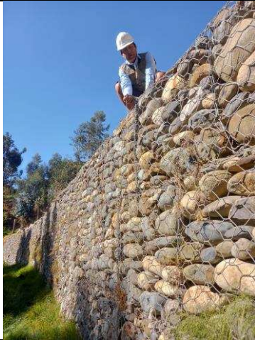
Foto N° 43: Inclinación del fuste de muro del tramo 6, prog. 0+055.
