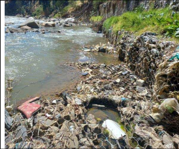
Foto N° 25: Detalle de la rotura (0.70x0.50) y (0.40x0.30) del colchón, prog. 0+080 y 0+084.
