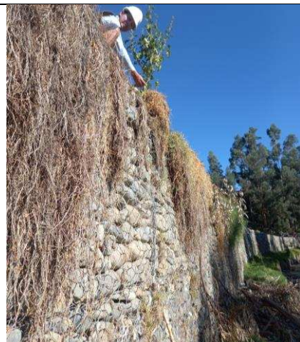
Foto N° 60: Inclínación del fuste de muro del tramo 11, prog. 0+105.
