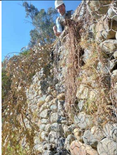
Foto N° 61: Inclínación del fuste de muro del tramo 12, prog. 0+115.
