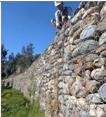
Foto N° 39: Inclinación del fuste de muro del tramo 4, prog. 0+035.
