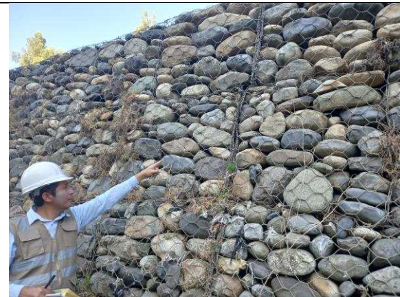
Foto N° 75: Relleno de rocas inadecuadas, diámetros de rocas desde 10cm hasta 40cm.
