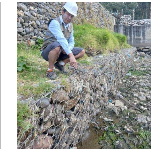
Foto N° 35: Volcamiento de rocas en la puntera del muro (1.0x0.4), prog. 0+014.
