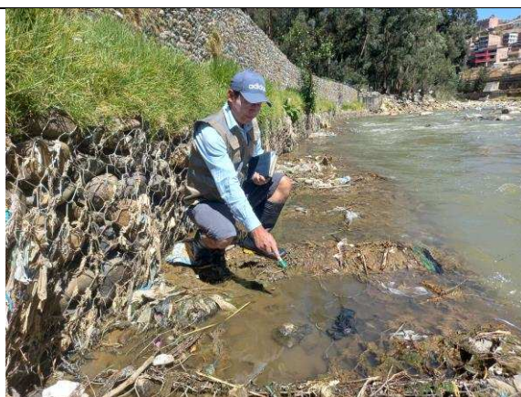
Foto N° 17: Rotura de malla del colchón antisocavante, prog. 0+074.
