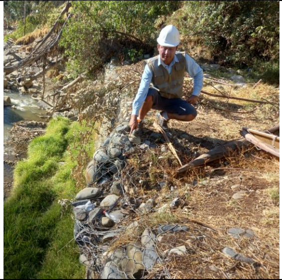
Foto N° 74: Hundimiento de la corona a causa de caída de árbol, prog. 0+113.
