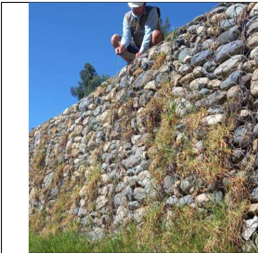
Foto N° 33: Inclinación del fuste de muro del tramo 1, prog. 0+005
