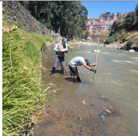
Foto N° 10: Medición de la deflexión del colchón reno y socavación en el tramo 5.
