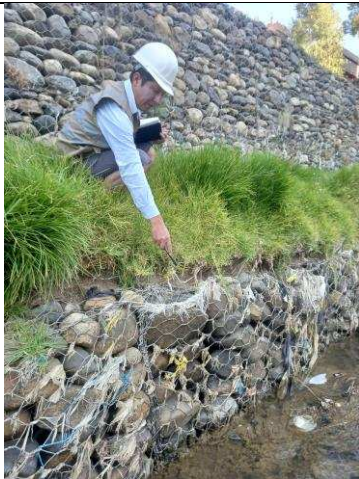
Foto N° 45: Desplazamiento de rocas en la puntera del muro (0.65x0.55), prog. 0+055.
