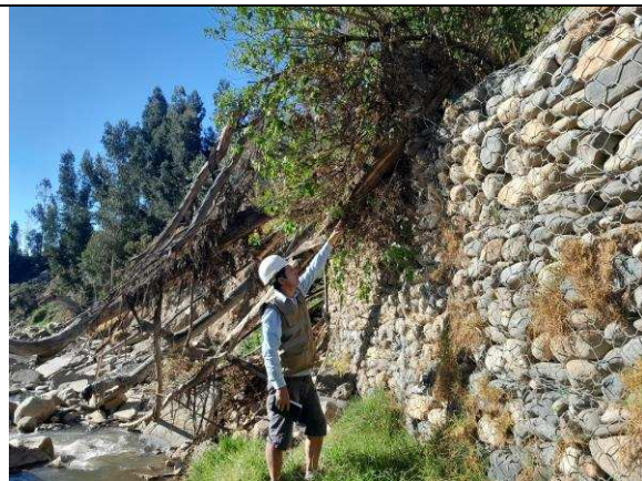
Foto N° 66: Volcamiento de la última fila de gaviones, prog. 0+120.
