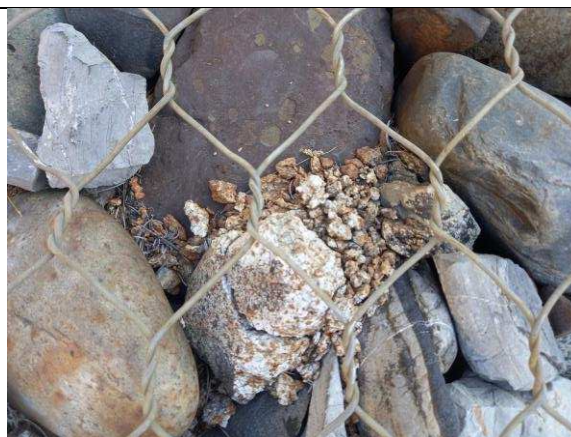
Foto N° 68: 14 rocas con intemperismo en un área de (5mx1.5m), prog. 0+030-0+035.
