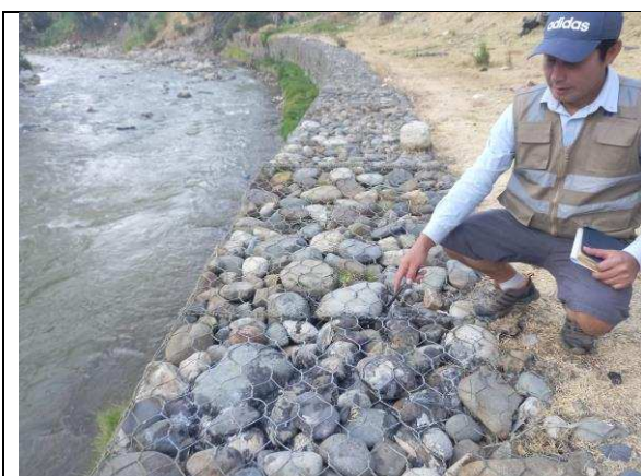
Foto N° 69: Área (1.1m*0.8m) quemada sobre la corona del muro en la progresiva 0+018.
