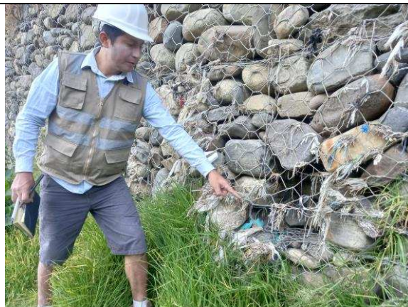
Foto N° 54: Rotura de malla del gavión (0.90x0.20) a una altura de 2.0m del fuste de muro, prog. 0+084.
