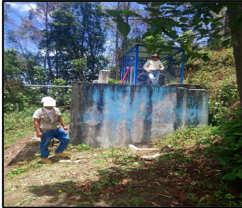
Fotografía 5 Reservorio de Almacenamiento
