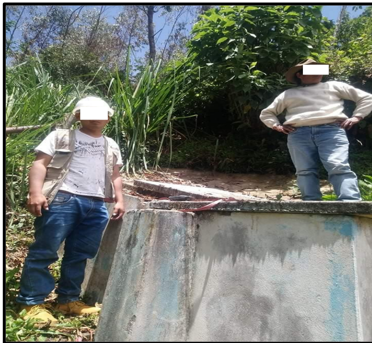
Fotografía 4 Cámara de captación
