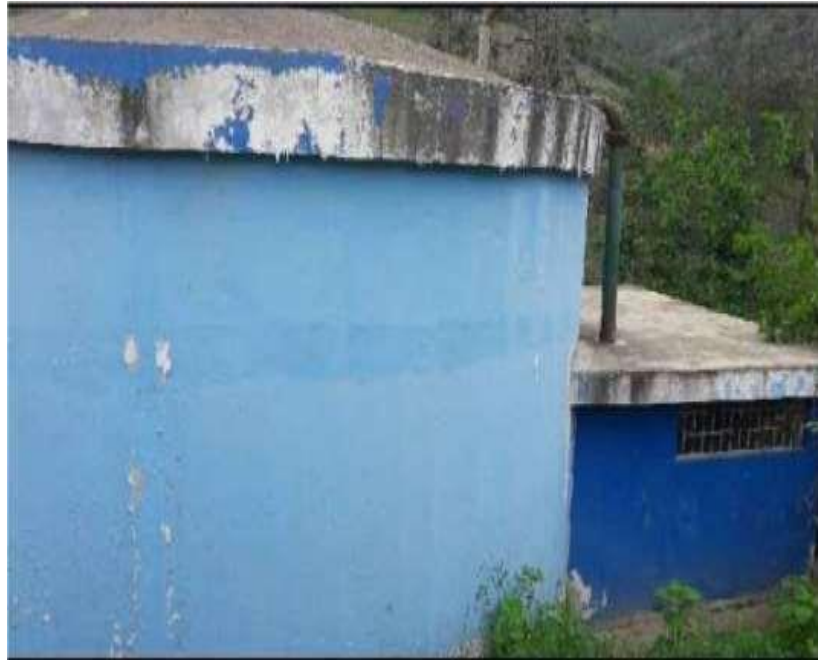
Imagen 04: Observamos al Reservorio que tiene la forma circular y es de concreto, podemos también apreciar la antigüedad de la estructura y la eflorescencia en su exterior,
