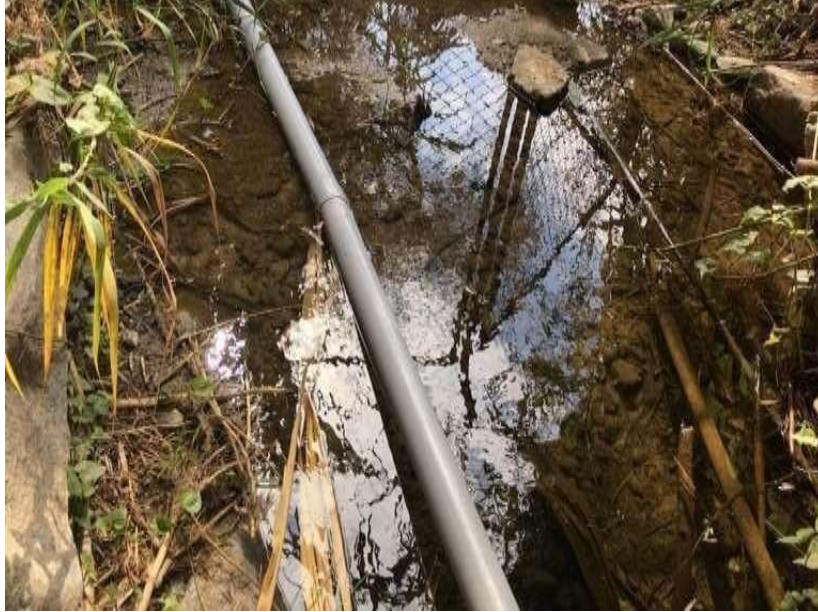
Imagen 03: observamos la línea de conducción que se encuentra expuesto al aire libre, lluvias, cambios de temperatura y diferentes factores.
