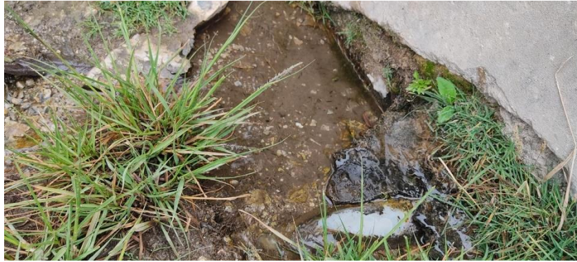
Imagen 11. Filtración en la tubería de salida de la cámara rompe presión
