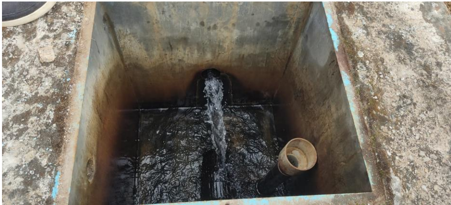
Imagen 8. Interior cámara rompe presión N° 2
