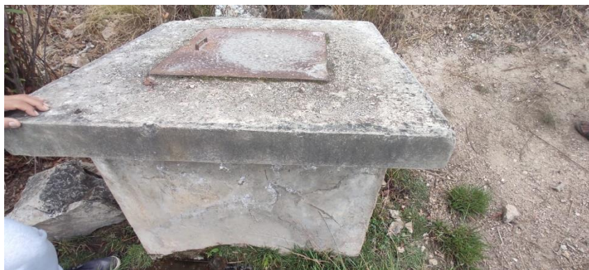
Imagen 10. Cámara rompe presión N° 4
