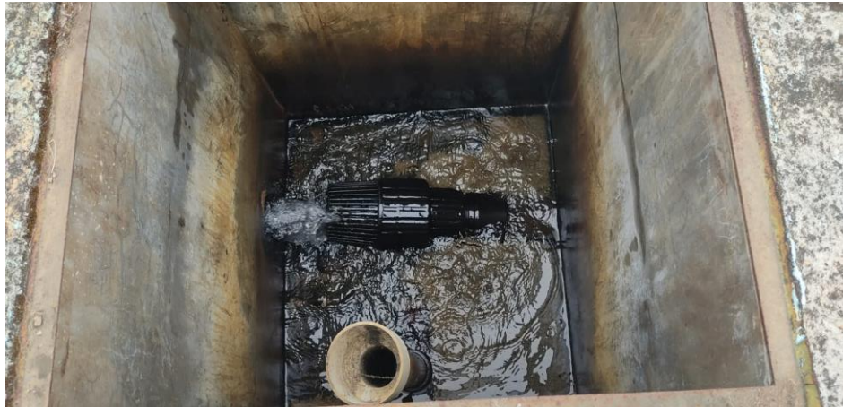
Imagen 6. Interior de la cámara rompe presión
