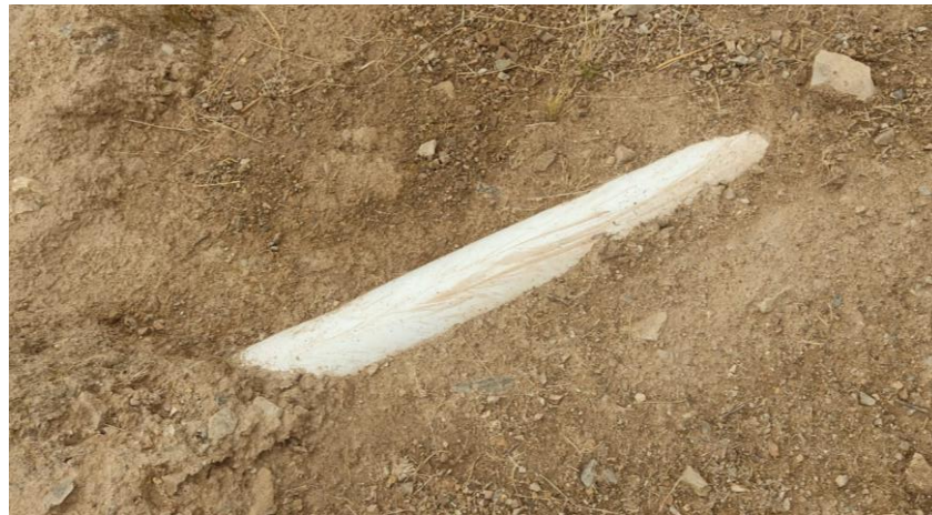
Imagen 3. Tubería de la línea de conducción expuesta
