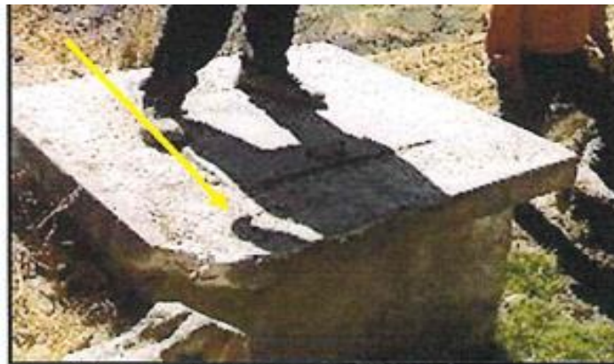
Imagen 9. Cámara rompe presión N° 3
