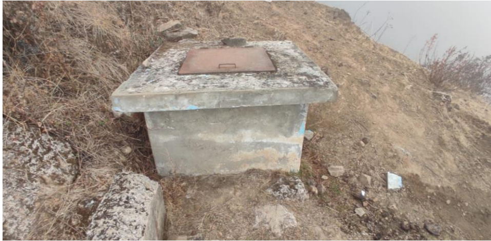
Imagen 7. Cámara rompe presión N° 2
